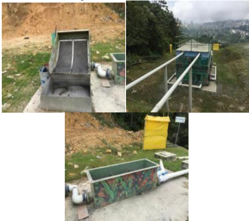
Imagen 10: PTAR de Baños Portátiles
