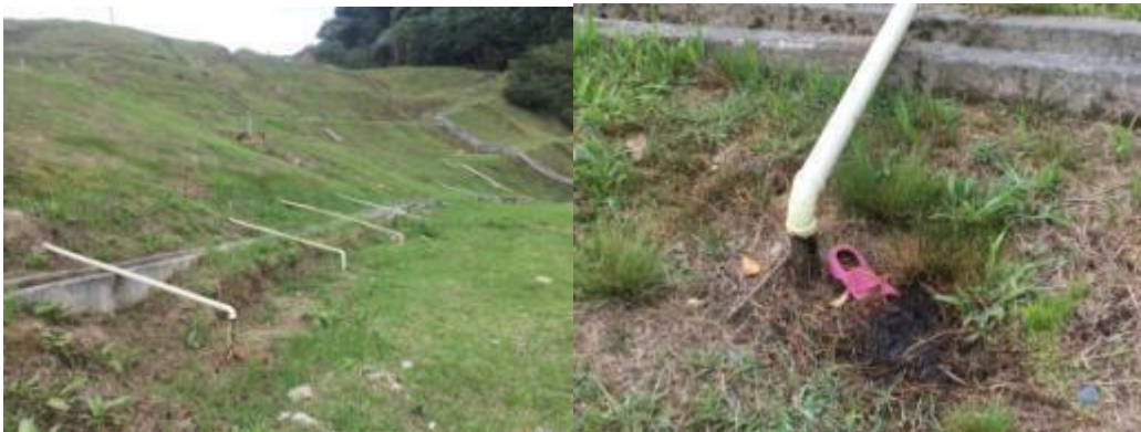
Imagen 9: Fuga de Lixiviados en la Zona de Clausura
