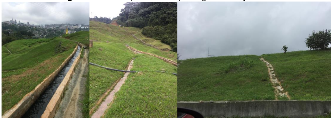
Imagen 17: Canales perimetrales para aguas lluvia y lixiviados
