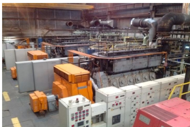
Cuarto de máquinas central de generación ENAM
