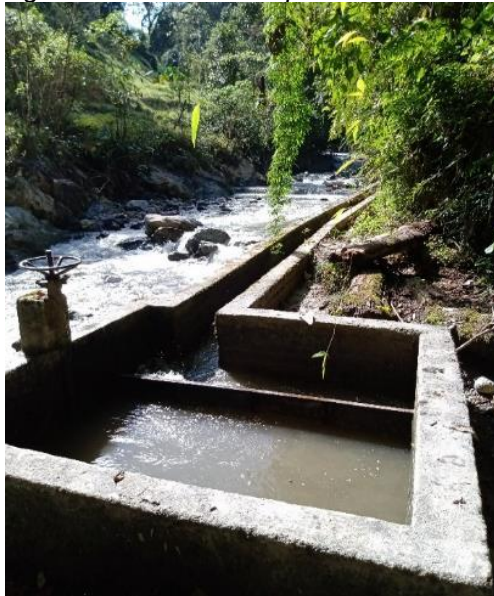
Imagen 11. Estructura de pretratamiento No. 1
