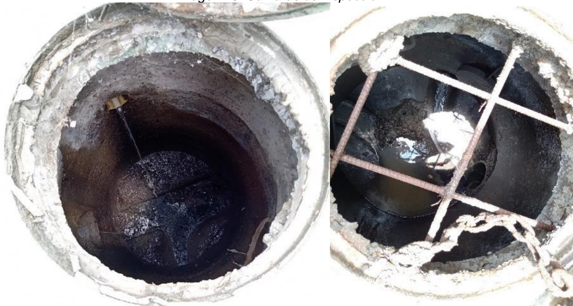
Imagen 25. Cámaras de inspección.
