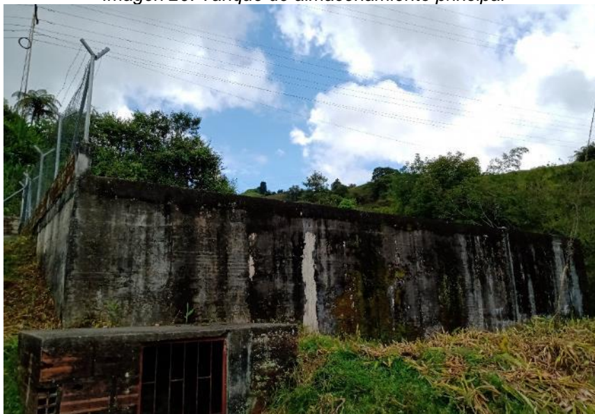
Imagen 20. Tanque de almacenamiento principal
