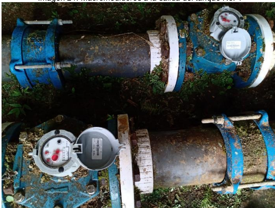
Imagen 21. Macromedidores a la salida del tanque No. 1
