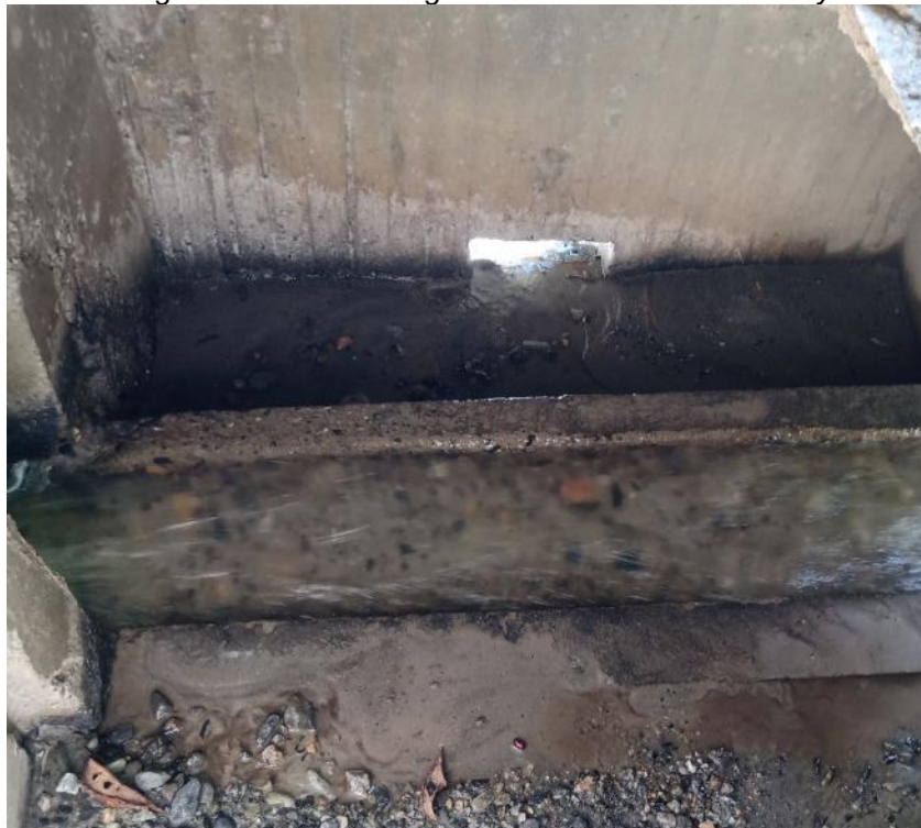
Imagen 8. Cámara de regulación de caudal - Chambery
