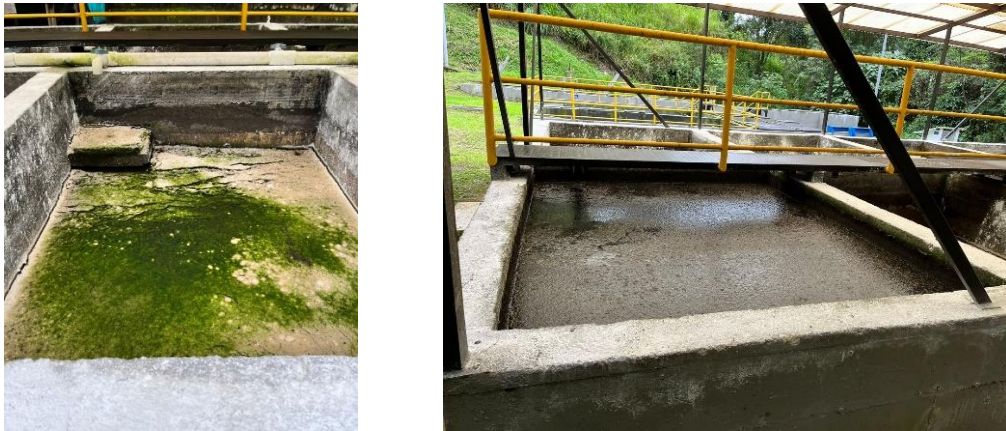
Imagen 17. Lechos de secado de lodos
