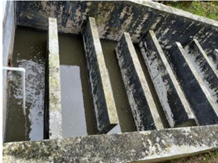
Imagen 14. Tanque de contacto de cloro
