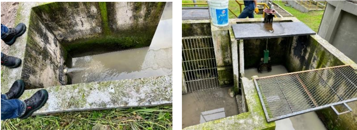
Imagen 5. Cámara de ingreso de aguas residuales
