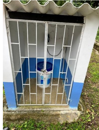
Imagen 15. Tanque de contacto de cloro
