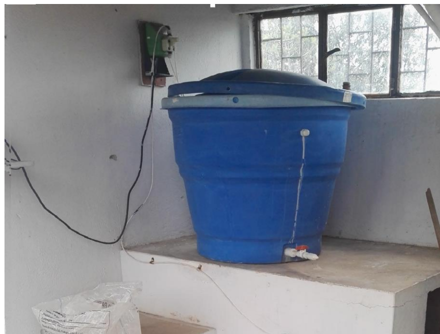
TANQUE PARAMEZCLA DE CLORO
