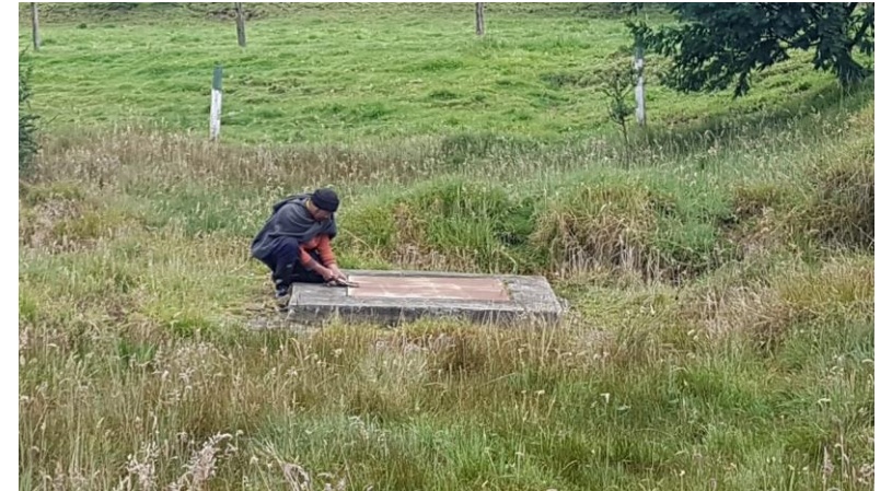
CERRAMIENTO PARA PROTECCION DE CAPTACIÓN DE AGUA
