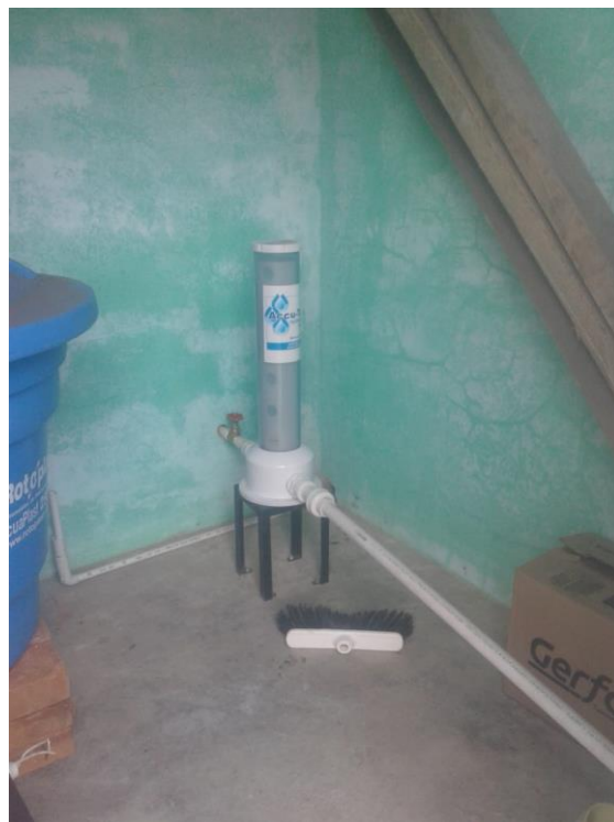
CLORADOR ACCU-TAB – TANQUE No. 2, SEMIENTERRADO
