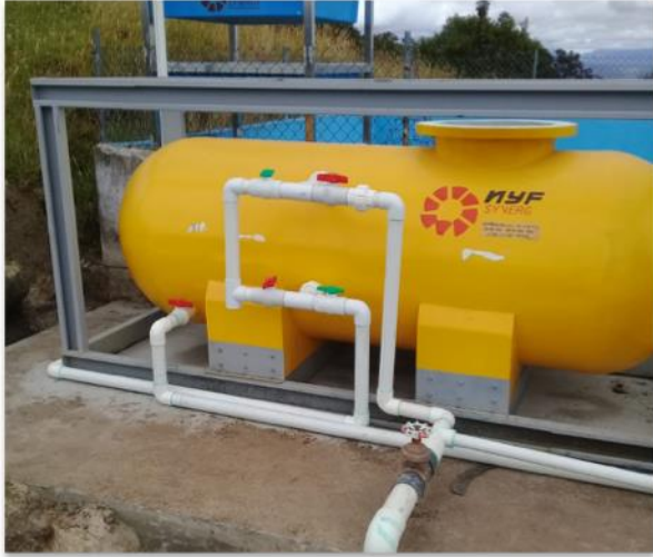
Acueducto Cutuaquer - Ipiales
