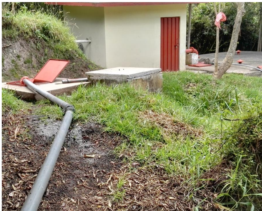
TANQUE ALMACE. Y CASETA DE BOMBEO
