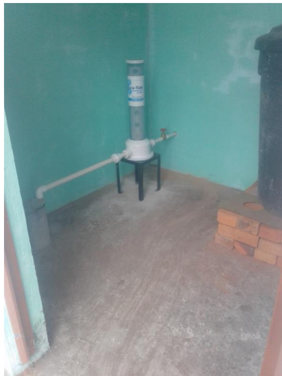
CLORADOR ACCU-TAB – TANQUE No. 1, SEMIENTERRADO
