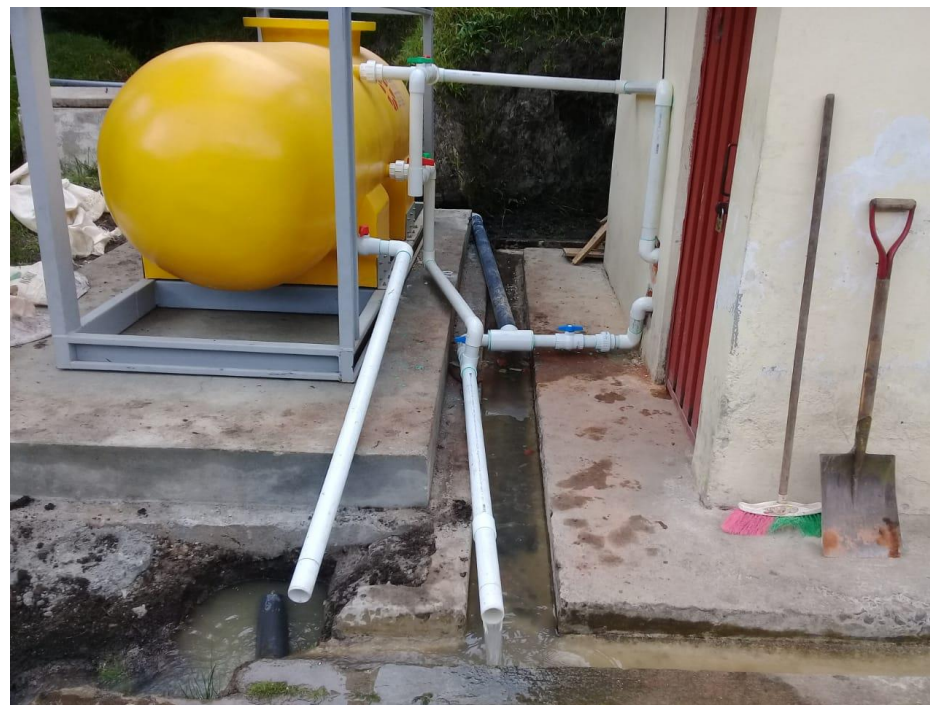
FILTRO RÁPIDO A LADO DE CASETA
