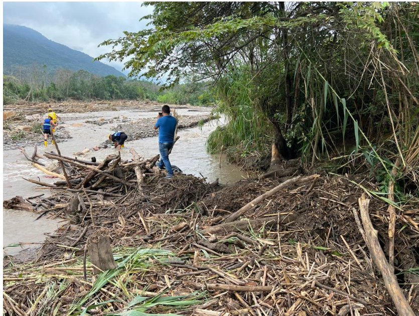
Imagen 5 Obstaculización en la entrada de la captación
