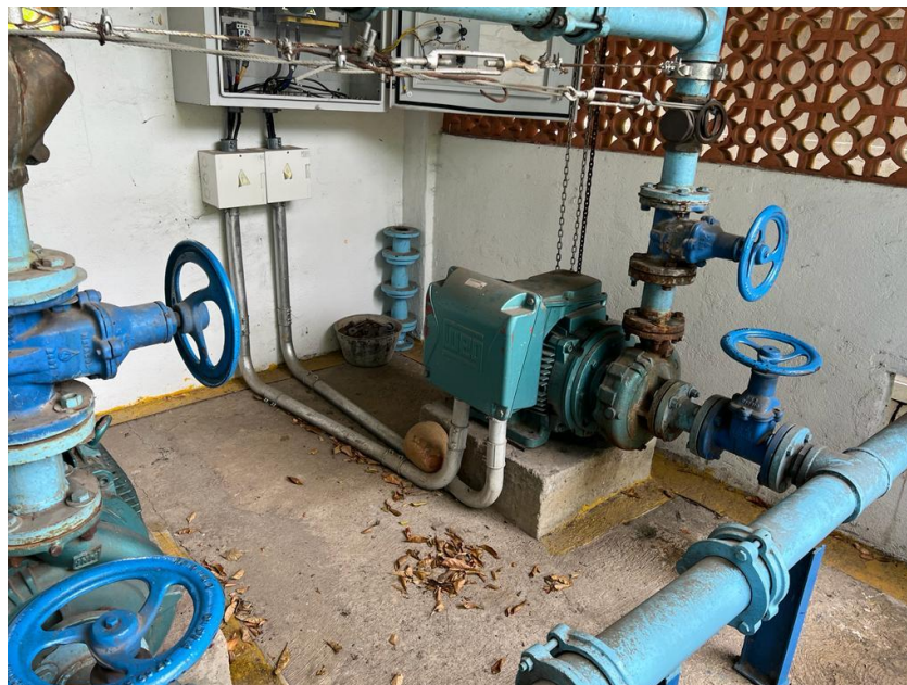
Imagen 29 Estaciones de bombeo PTAP
