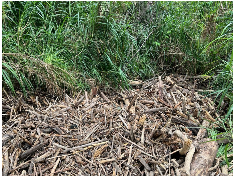
Imagen 6 Obstaculización en la entrada de la captación
