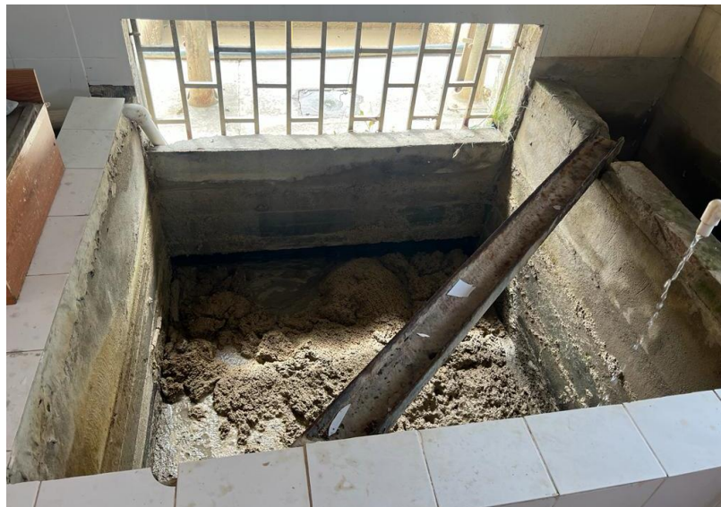
Imagen 11 Entrada de agua a la PTAP
