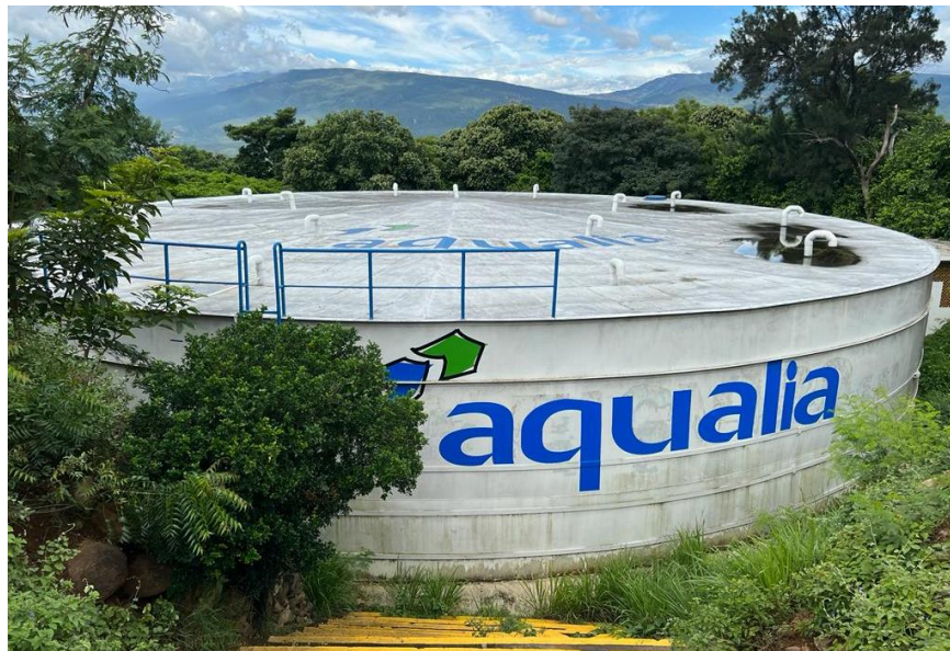
Imagen 22 Tanque Australiano PTAP
