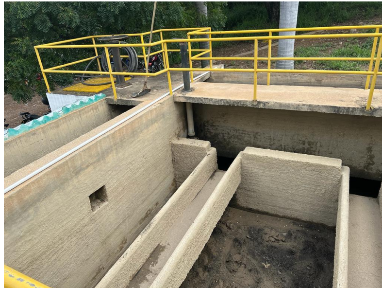
Imagen 16 Tanques de filtración
