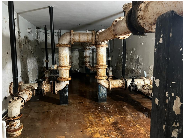
Imagen 18 Fugas en el tanque de cloración
