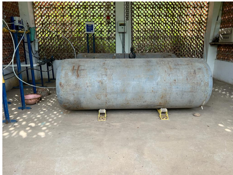
Imagen 17 Tanque de cloro gaseoso
