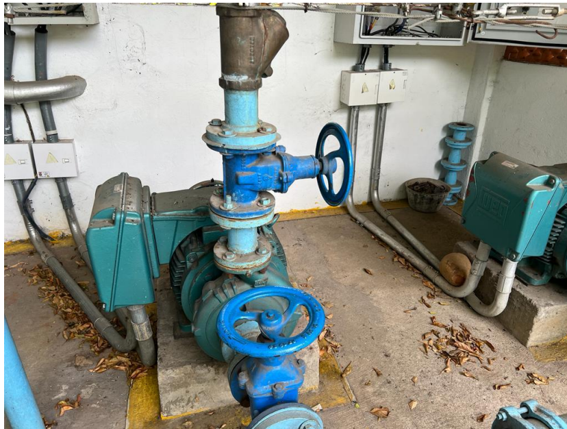
Imagen 28 Estación de bombeo PTAP
