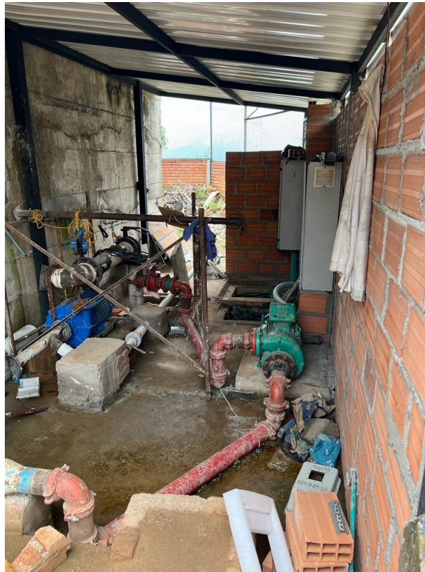
Imagen 30 Estación de bombeo Tanque Montevideo
