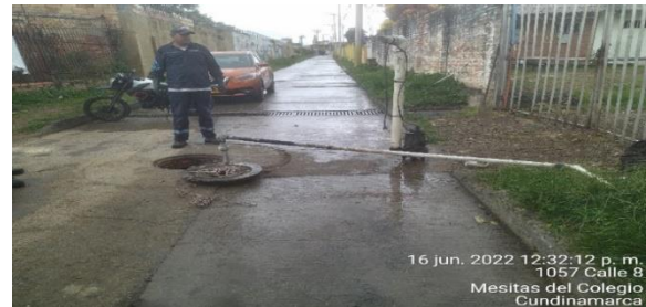
Bombeo 2 Las Pascuas
