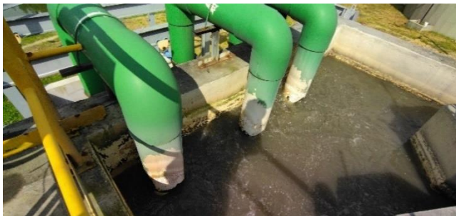
Entrada PTAR Madrid I
