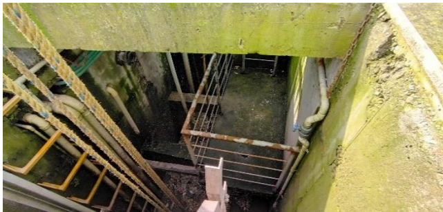
Entrada PTAR Madrid III Zaragoza
