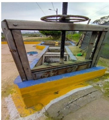
Entrada PTAR Madrid II
