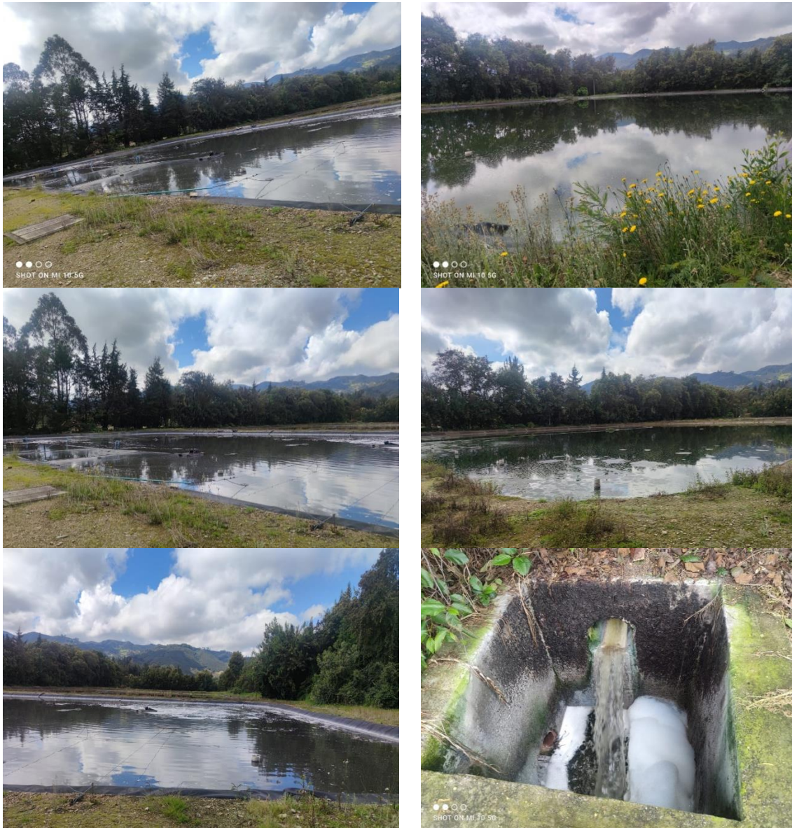
Imagen 3. Componentes Tratamiento secundario de la PTAR Casco Urbano
