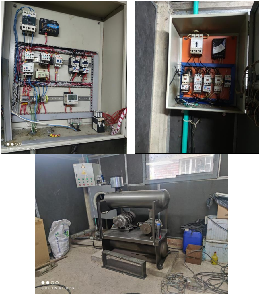
Imagen 4. Componente eléctrico PTAR Casco Urbano
