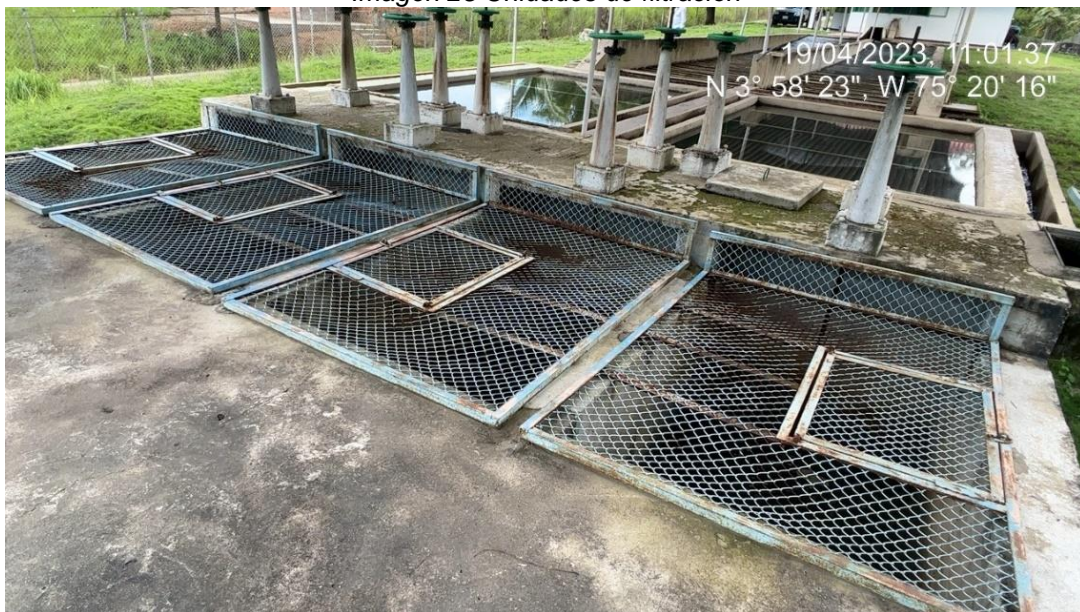
Imagen 25 Unidades de filtración
