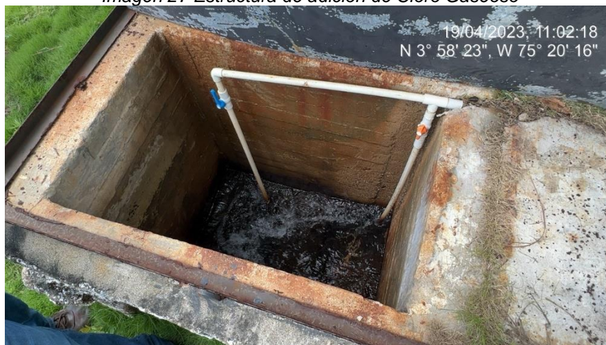
Imagen 27 Estructura de adición de Cloro Gaseoso
