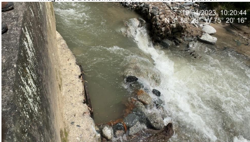
Imagen 15 Bocatoma lateral Río Anabá - Captación
