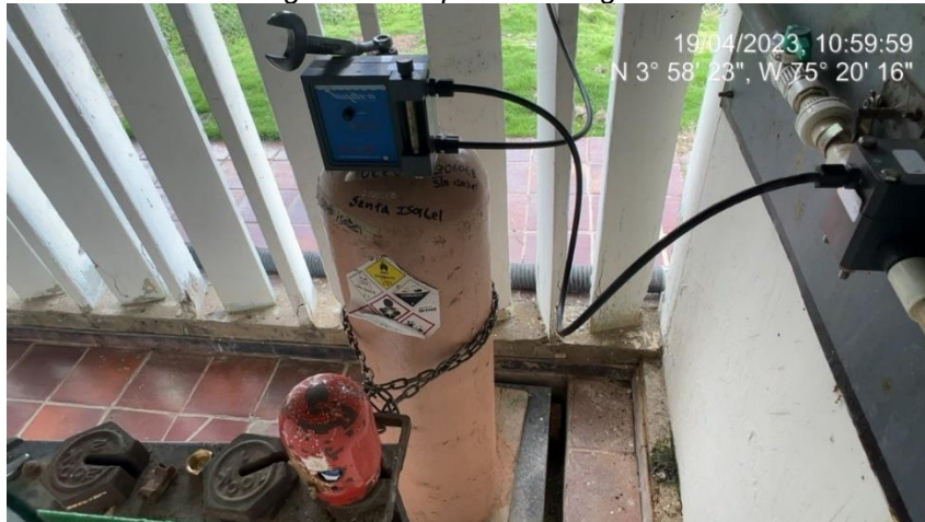
Imagen 26 Tanque de cloro gaseoso
