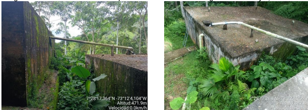
Imagen 19. Vista general de la conexión de los tanques de almacenamiento de agua cruda No. 1 y 2, mantenimiento deficiente.
