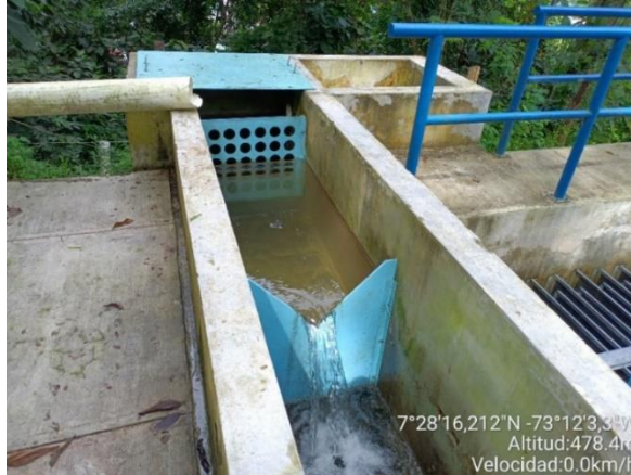
Imagen 11. Línea de aducción No. 2, canal de entrada y vertedero de la PTAP.
