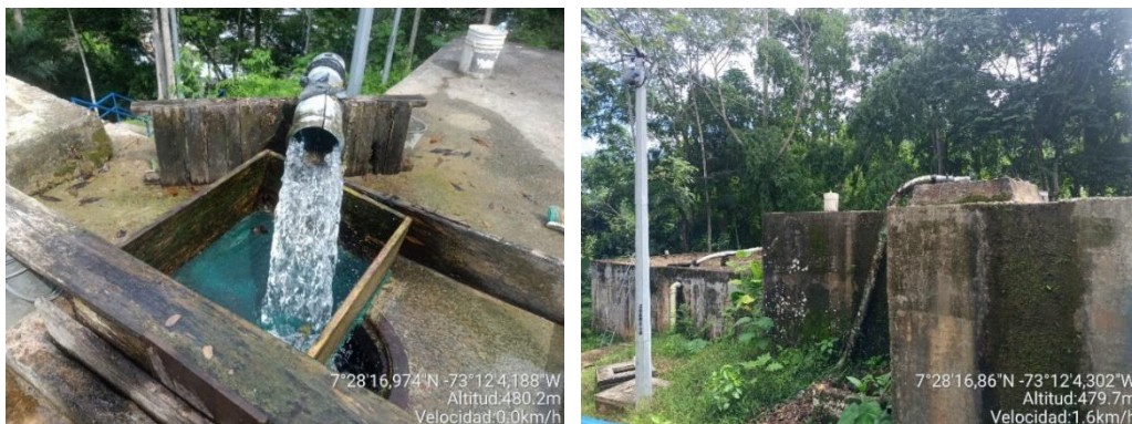
Imagen 20. Entrega de agua cruda al tanque de almacenamiento de agua cruda No. 1, mantenimiento deficiente y válvulas.
