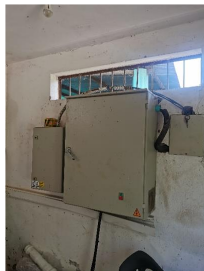
Controles eléctricos bomba lapicero
