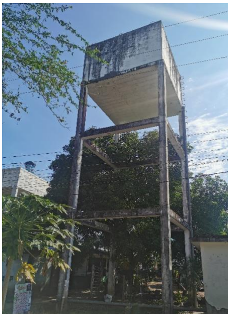
Imagen 8. Tanque elevado de almacenamiento
