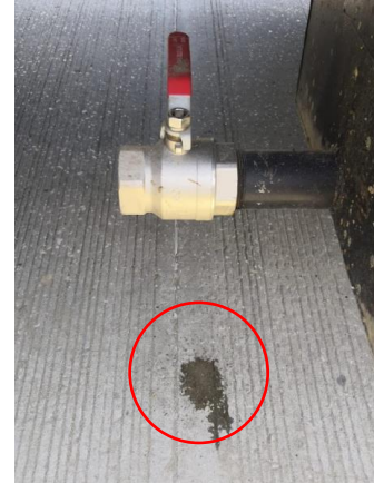
Imagen 46. Pérdida de líquido (Lixiviado)
