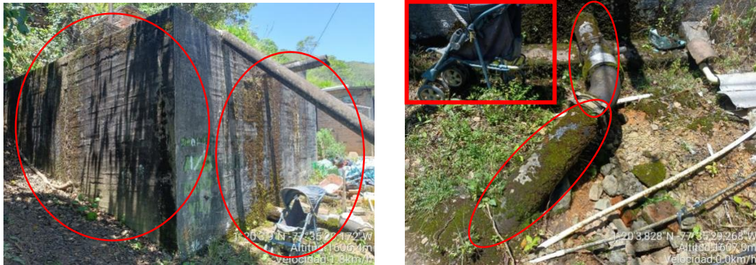
Imagen 10. Vista externa del tanque No. 1 de almacenamiento sector Siloé y cuarto de bombeo
