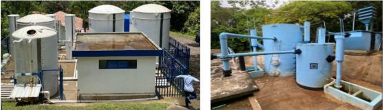
Fuente: visita de inspección del 5 al 6 de septiembre de 2023
