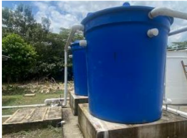
Imagen 17. Tanque de contacto.
