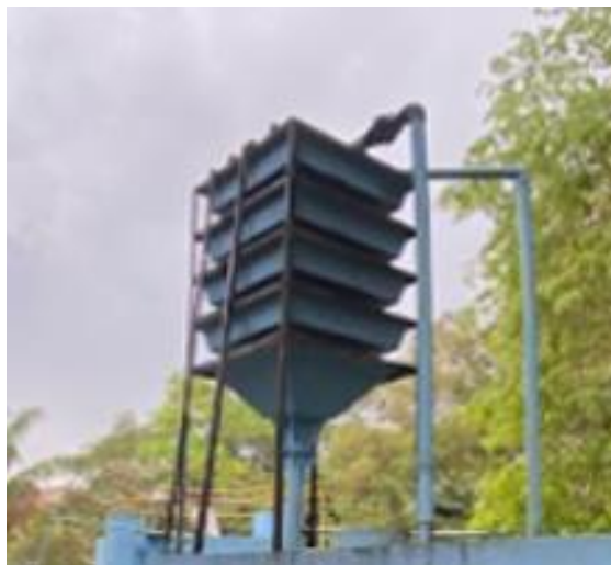
Imagen 8. Torre de aireación PTAP´S SERRAMONTE S.A. E.S.P.
