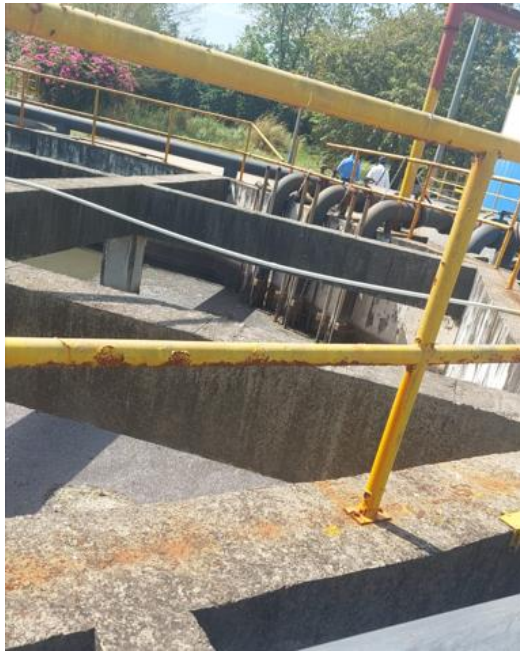
Tanque de bombeo
