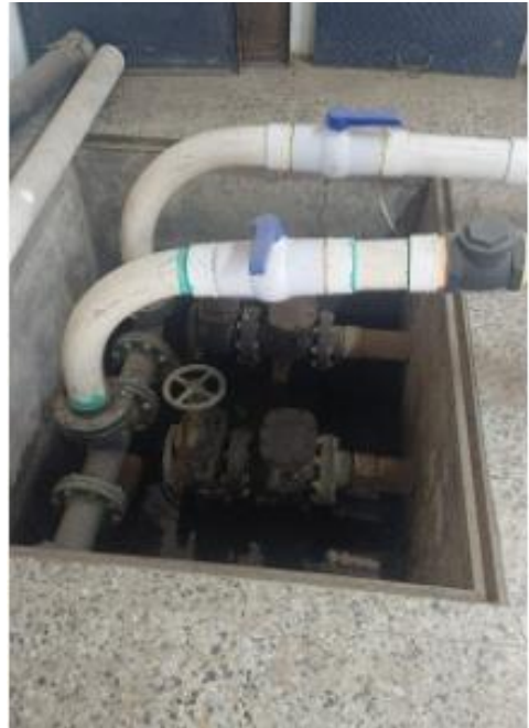
Sistema de bombeo
