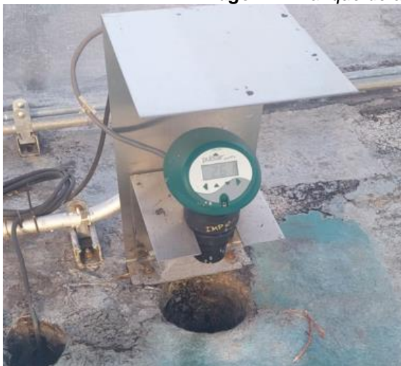
Sensor de nivel tanque norte
