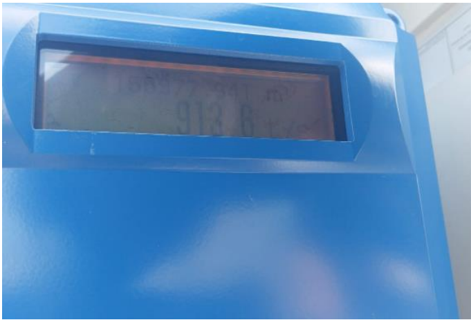
Macromedidor cámara de entrada
