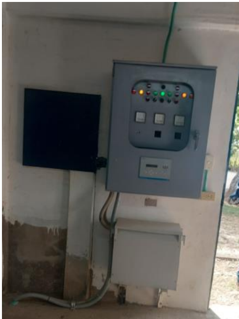
Centro de control
