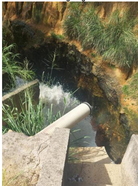
Imagen 25. Punto descarga agua tratada PTAR Yopal
