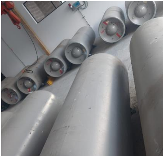
Cilindros de cloración
