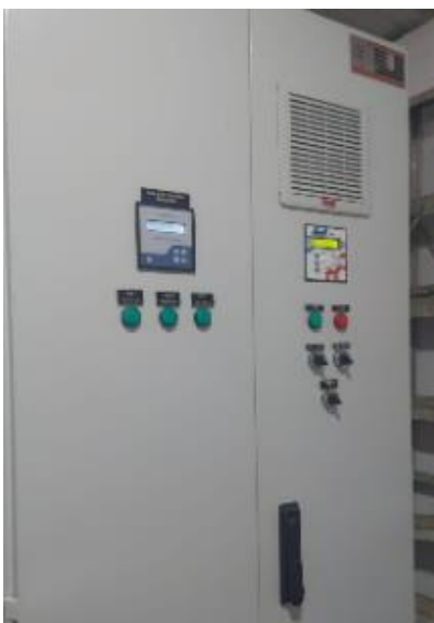
Centro de control de bombas
