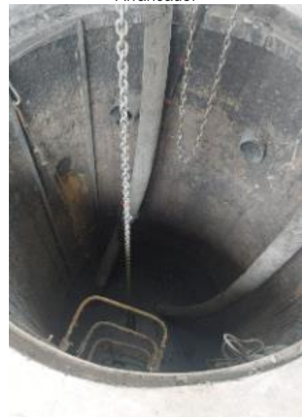
Sistema de bombeo
