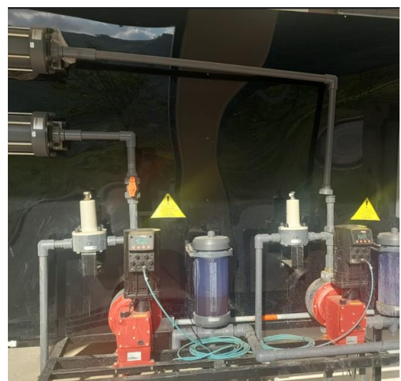
Bombas dosificadoras coagulante
