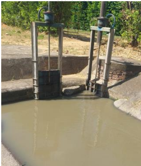
Canal entrada tratamiento biológico
