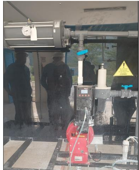
Bombas dosificadoras de cal dañada
