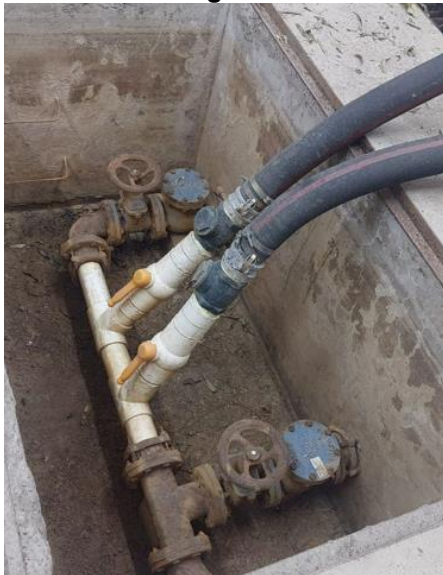
Sistema de bombeo
