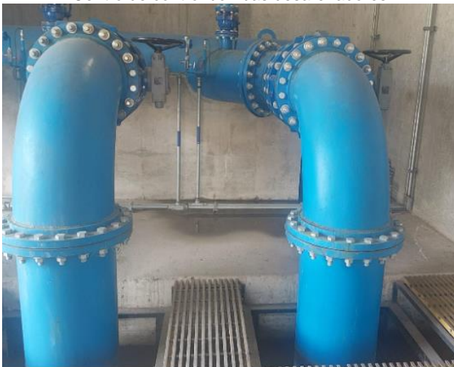
Bombas agua cruda
