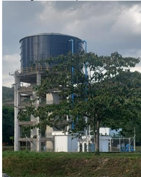
Imagen 10. Tanque de servicio
