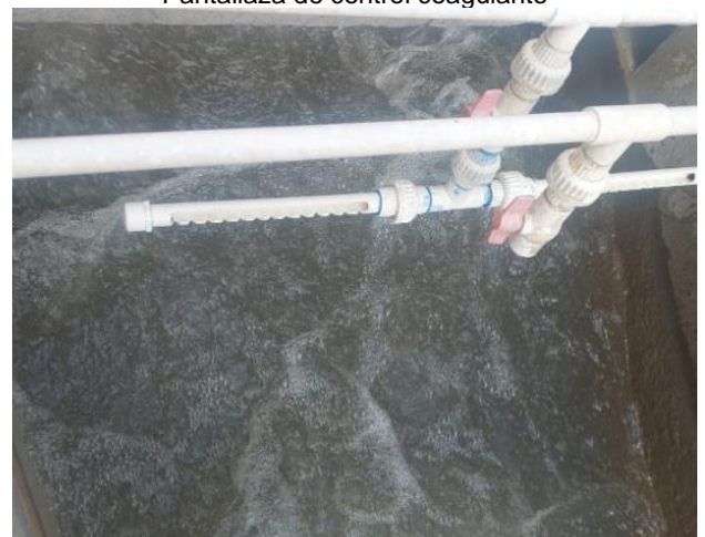
Sistema de difusores tipo Thomson
