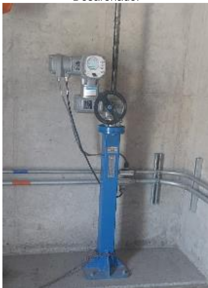
Bombas de desarenadores
