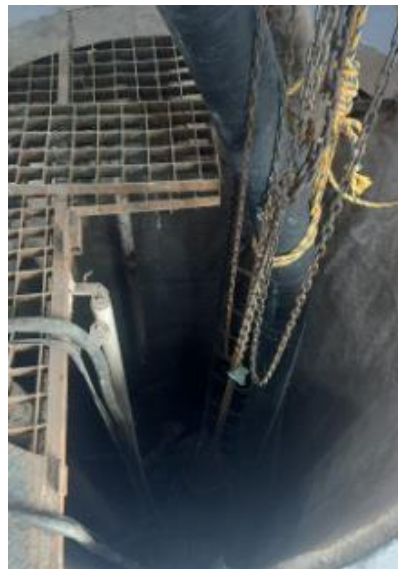
Sistema de bombeo
