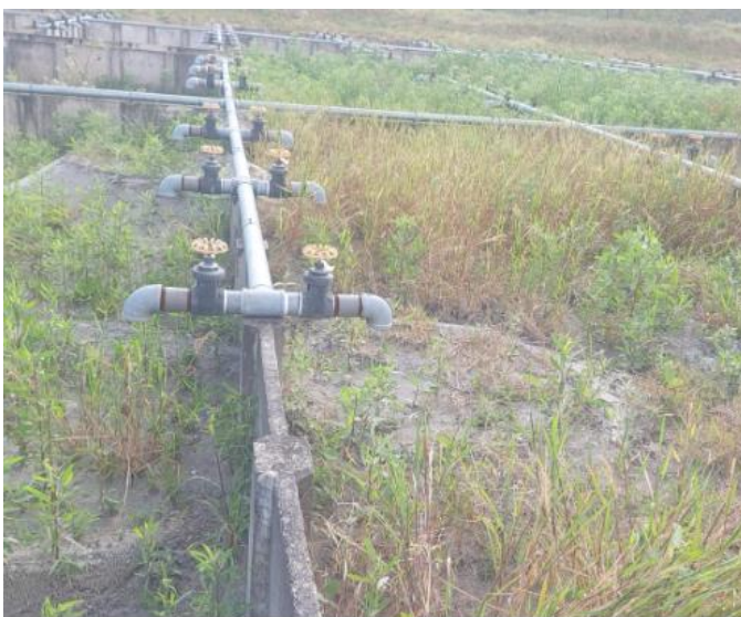
Módulo de secado desarenadores
