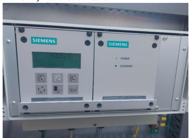
Macromedidor salida planta
