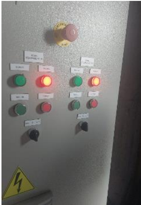
Centro de control bombas desarenadores
