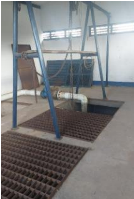
Sistema de bombeo
