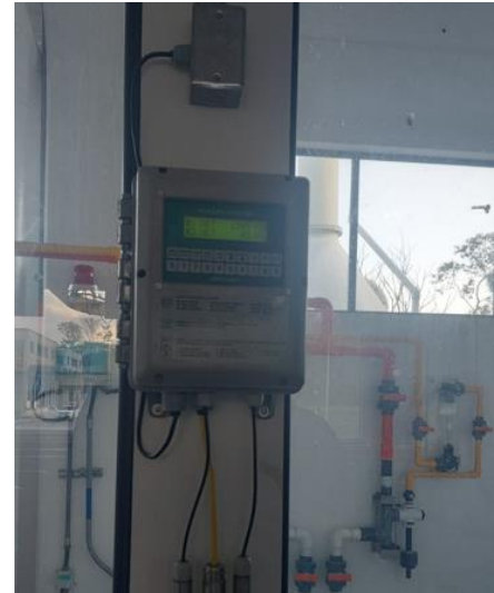
Control de pesaje cuarto de cloración
