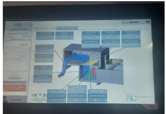
Pantalla de control bombeo de agua cruda
