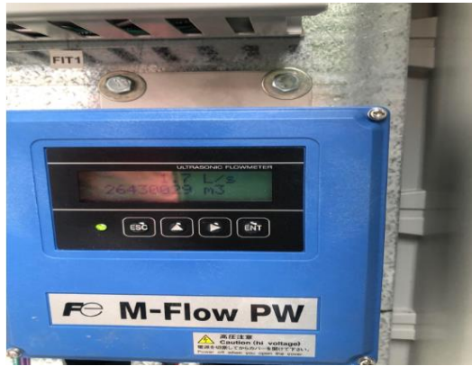
Imagen 28. Macromedidores instalados en redes de conducción operativos
