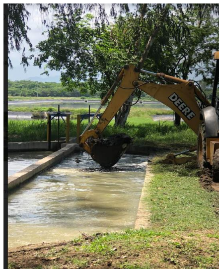
Imagen 51. Canal de vertimiento final
