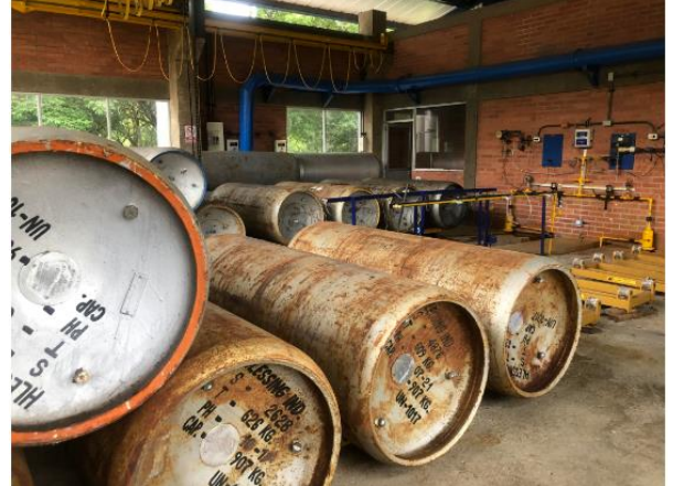
Imagen 25. Dosificación de Cloro gaseoso
