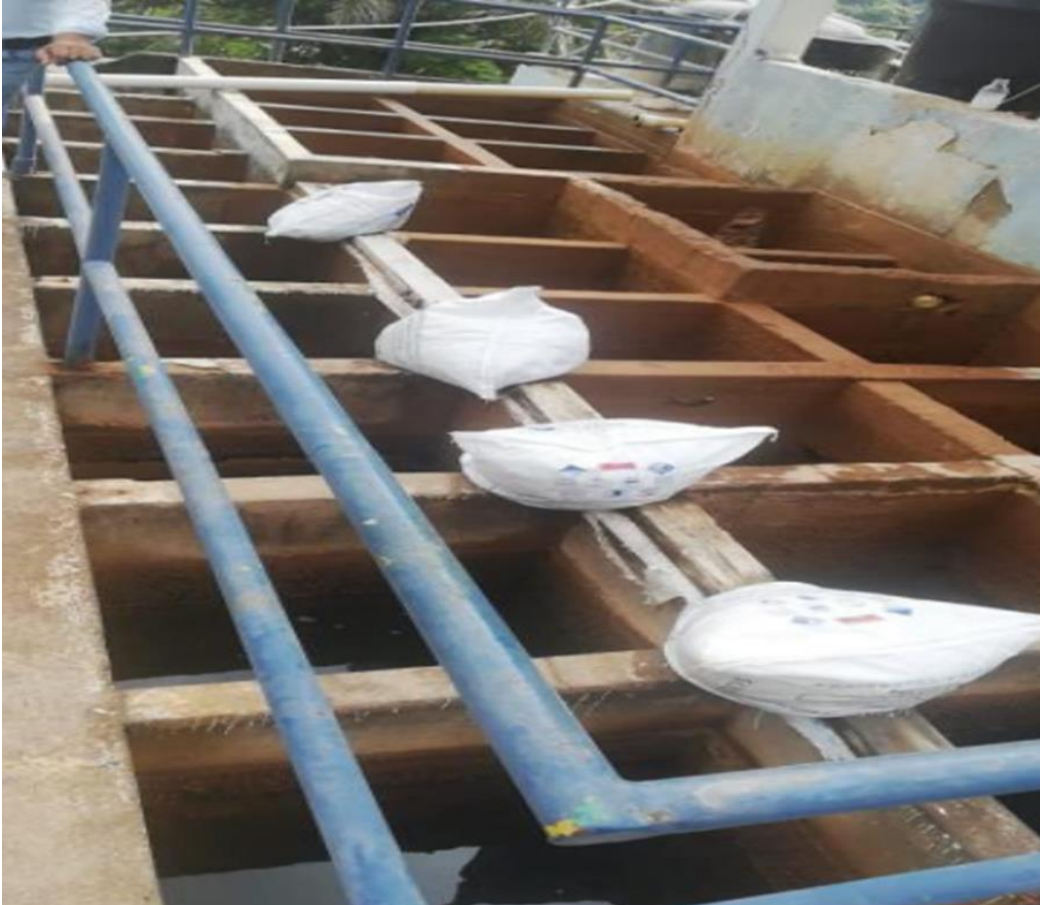
Imagen 12. Floculadores sistema de acueducto de Puerto Leguízamo.
