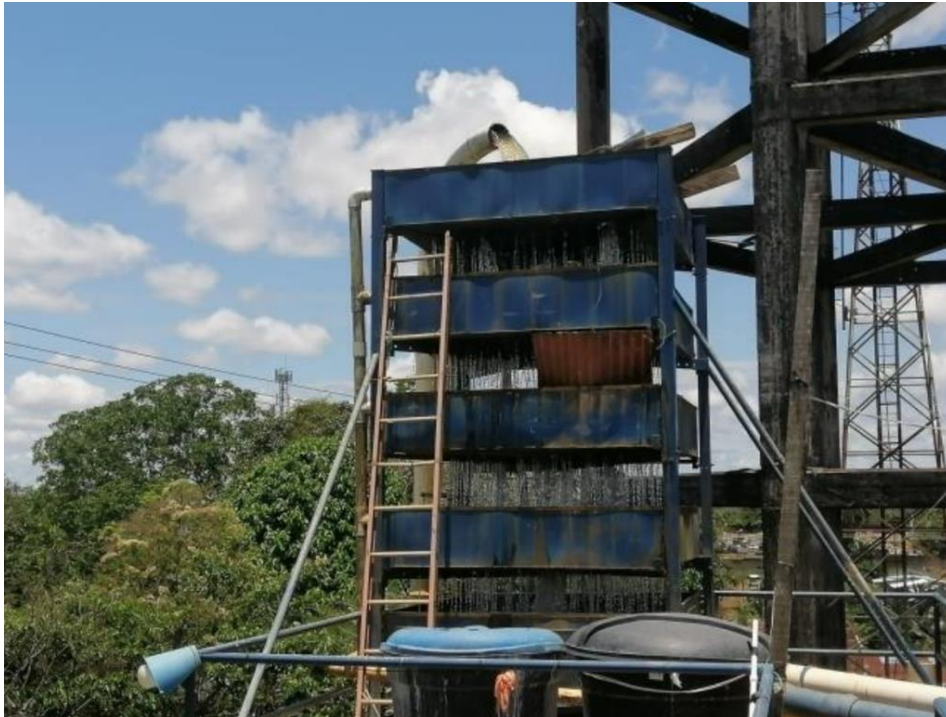
Imagen 10. Bandejas de aireación sistema de acueducto de Puerto Leguízamo.
