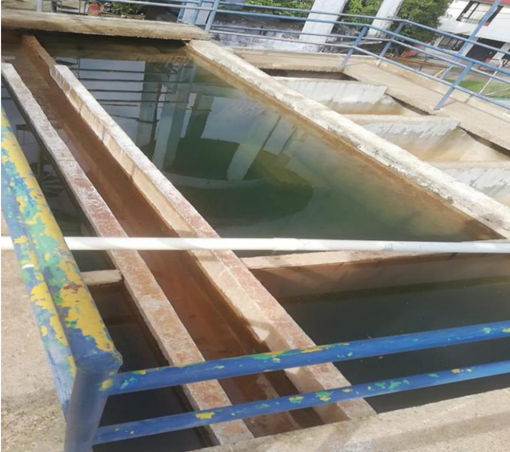
Imagen 13. Sedimentadores sistema de acueducto de Puerto Leguízamo.
