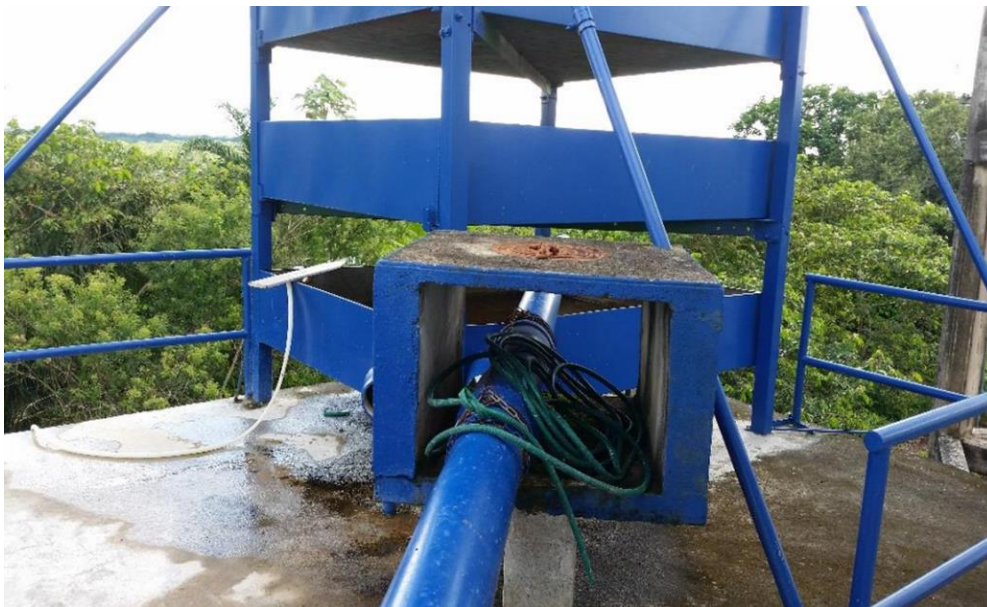
Imagen 5. Aducción sistema de acueducto de Puerto Leguízamo.
