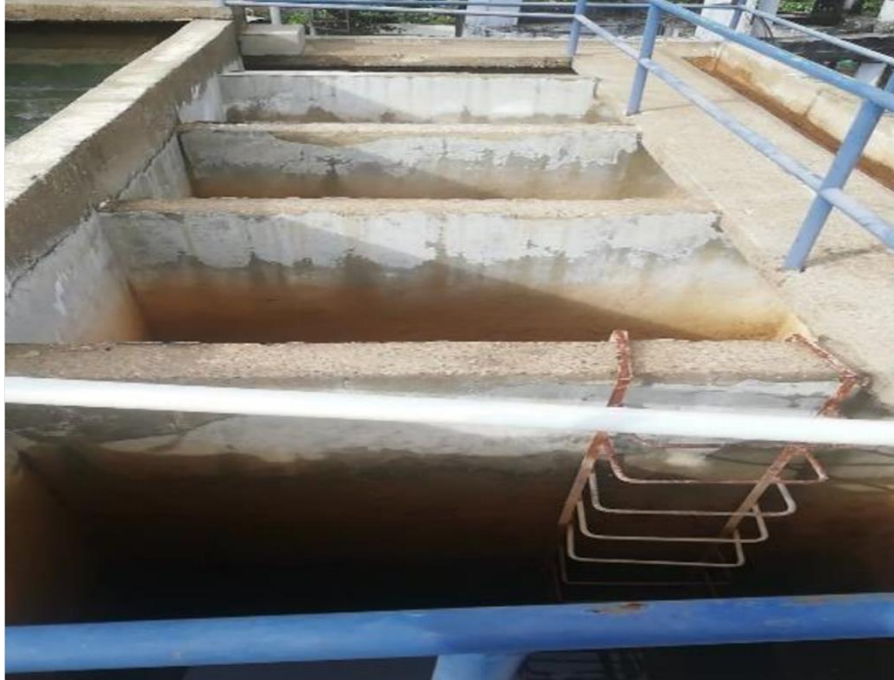
Imagen 14. Filtros sistema de acueducto de Puerto Leguízamo.
