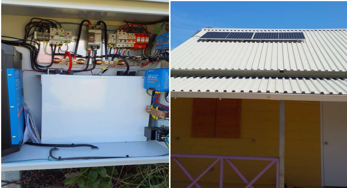
Ilustración 37 Sistemas Solares Fotovoltaicos FENOGE Providencia
