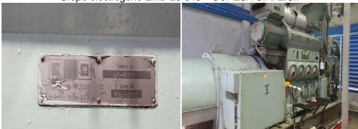
Grupo electrógeno EMD L8-645 – SOPESA S.A. E.S.P
