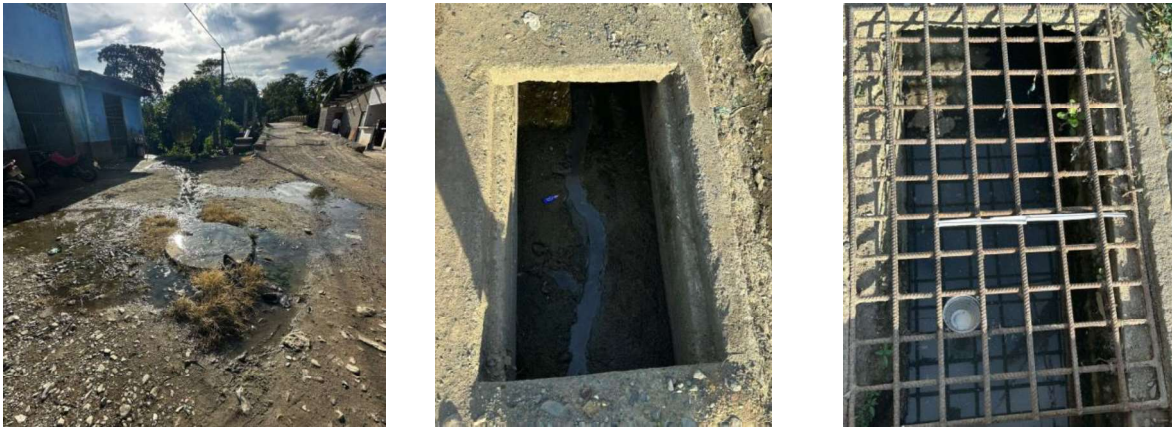
Imagen 11. Rebosamiento y colmatación sistema de alcantarillado
