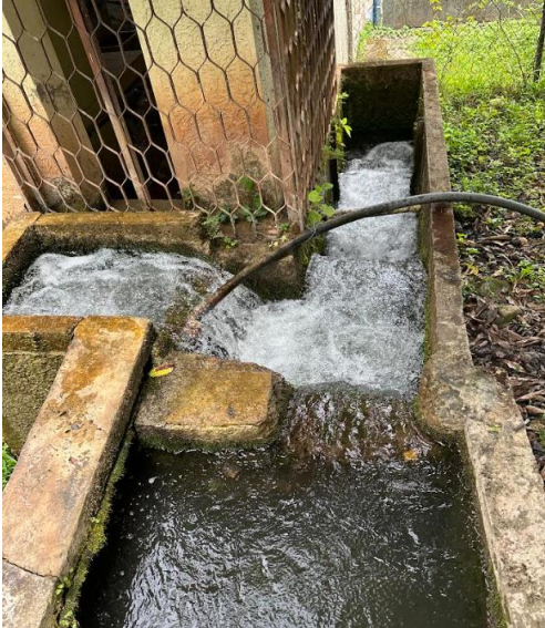
Canal de entrada a la PTAP
