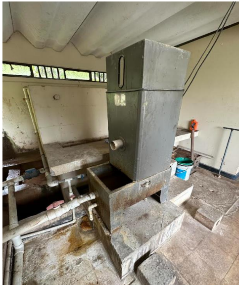
Dosificadores de sulfato
