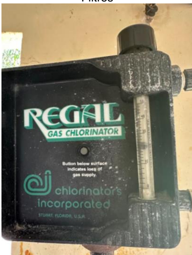
Dosificador cloro gaseoso
