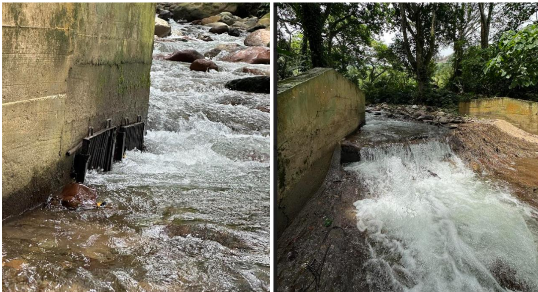
Imagen 4. Bocatoma lateral y de fondo sobre el río Manaure
