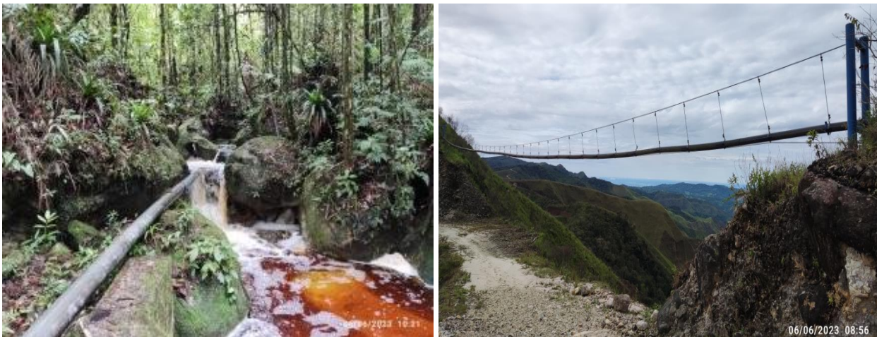
Imagen 8. Línea de aducción
