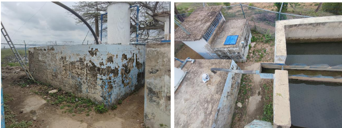
Imagen 18. Filtros y tanque, corregimiento de Guaquiri
