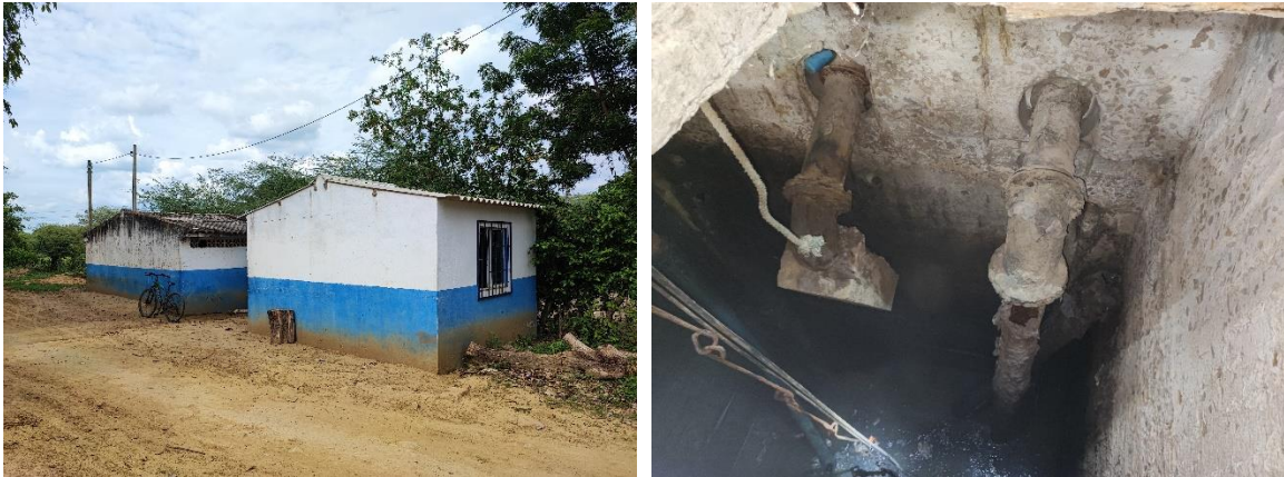
Imagen 25. Estación de Bombeo de Aguas Residuales (EBAR)
