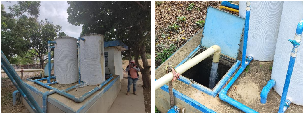
Imagen 15. Filtros y tanque provisional, corregimiento de Heredia
