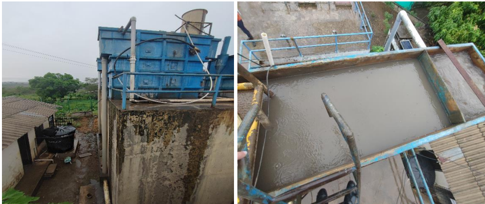
Imagen 5. Desarenador en PRFV, casco urbano
