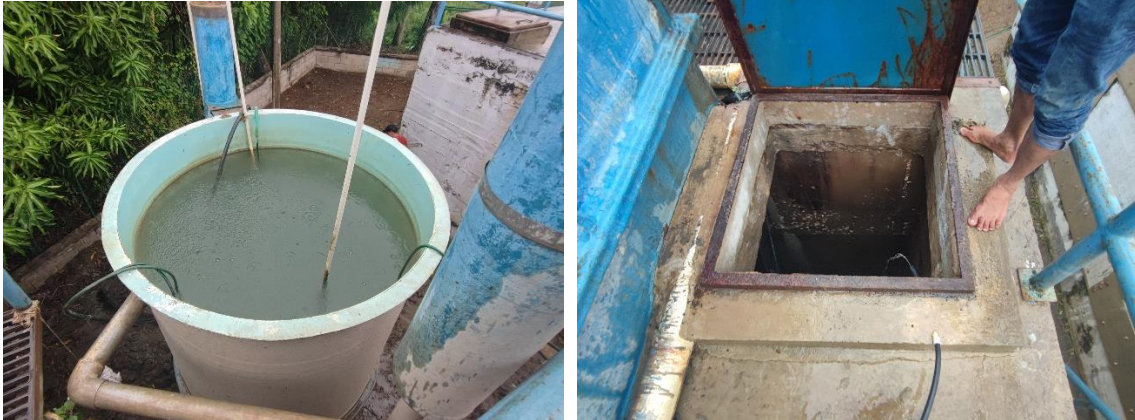
Imagen 12. Filtración y módulo de desinfección del área urbana
