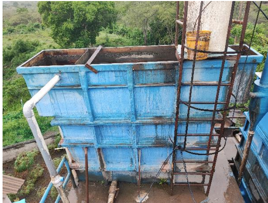
Imagen 6. Módulo del desarenador no operativo, casco urbano
