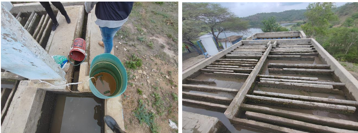
Imagen 17. floculación y sedimentación, corregimiento de Guaquiri
