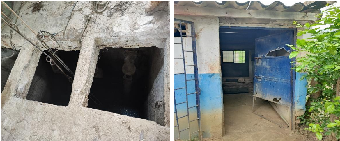
Imagen 26. Estación de Bombeo de Aguas Residuales (EBAR)
