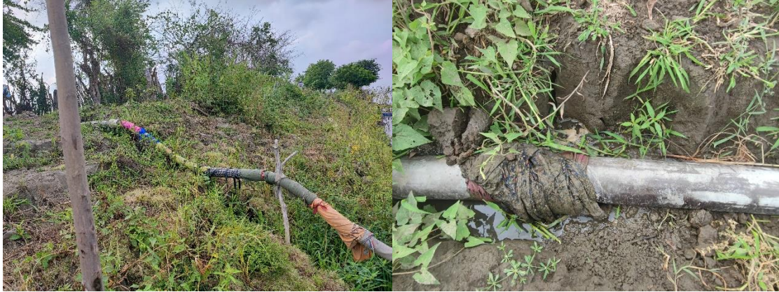
Imagen 7. Línea de aducción, corregimiento de Heredia
