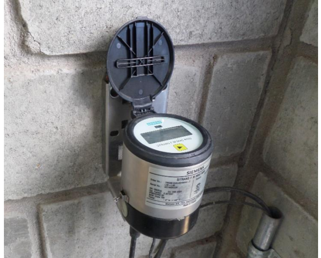
Medidor pozo Vocacional
