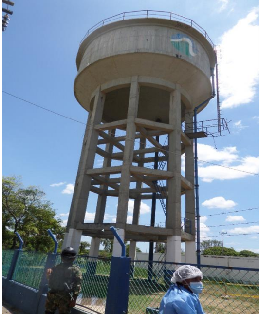
Tanque elevado San José
