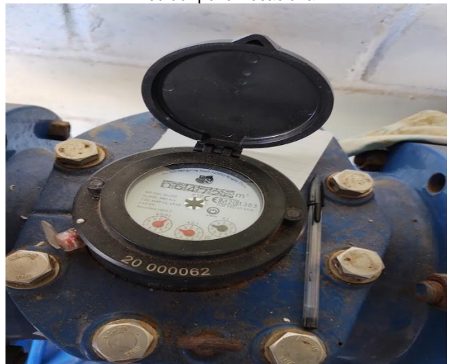
Medidor pozo Carraipía
