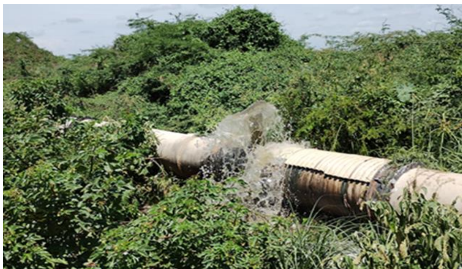
Imagen 32. Rotura red de conducción Alcantarillado.
