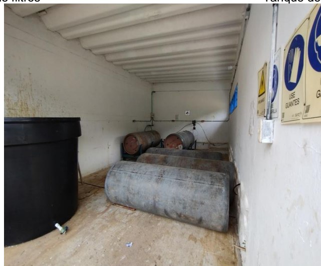
Almacenamiento de tanques de cloro gaseoso Fuente: Registro fotográfico SSPD – visita junio de 2023.
