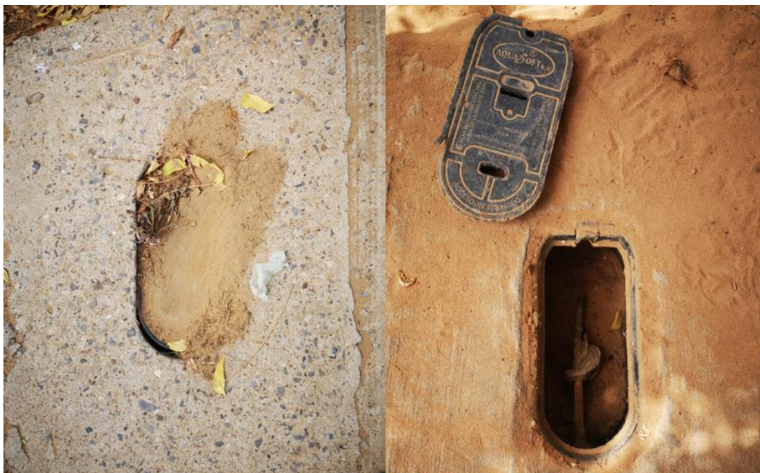
Imagen 44. Micromedidor tapado y desinstalado.
