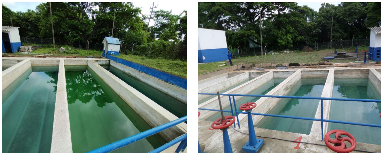
Sistema de filtración
