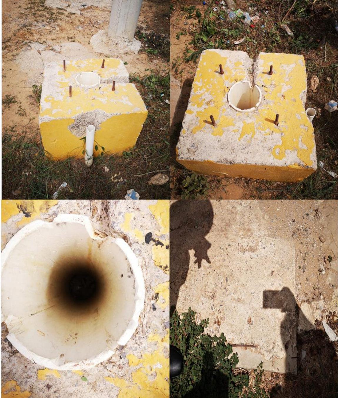
Imagen 48. Pozo Altos de Parrantial y zona de macromedidor (desinstalado).
