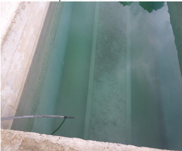
Entrada de filtros
