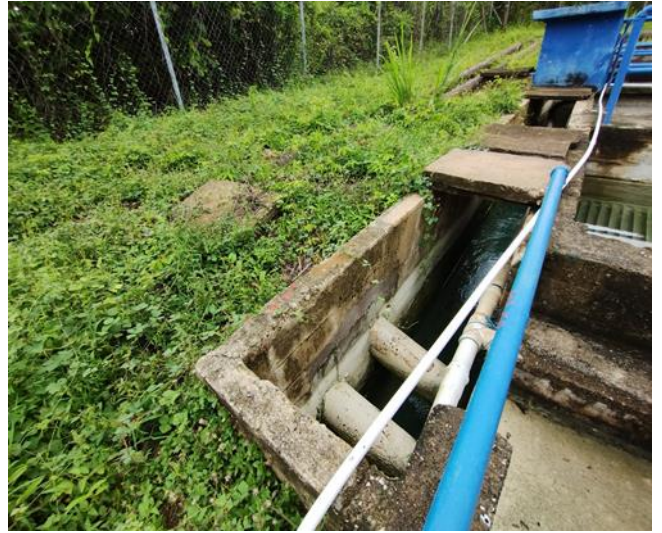
Ingreso del agua de los pozos al sistema de filtración
