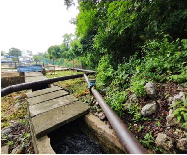
Interconexión pozos 6a y 6b
