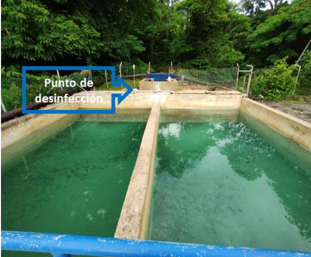
Entrada a la planta antes de los desarenadores
