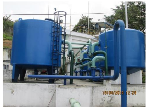
Unidades de filtración
