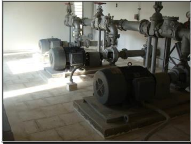
Imagen 19. Estaciones de bombeo
