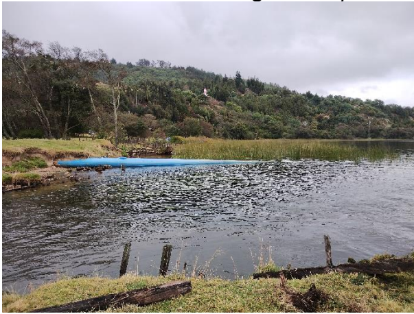
Captación Laguna de Tota
