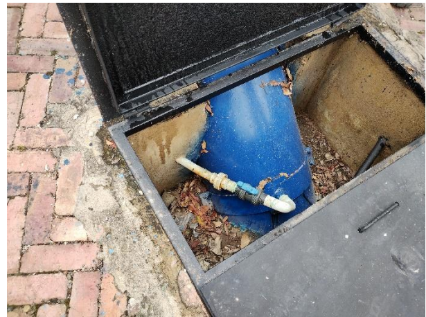
Salida del tanque de aguas filtradas
