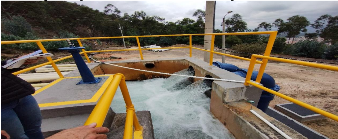
Cámara de llegada
