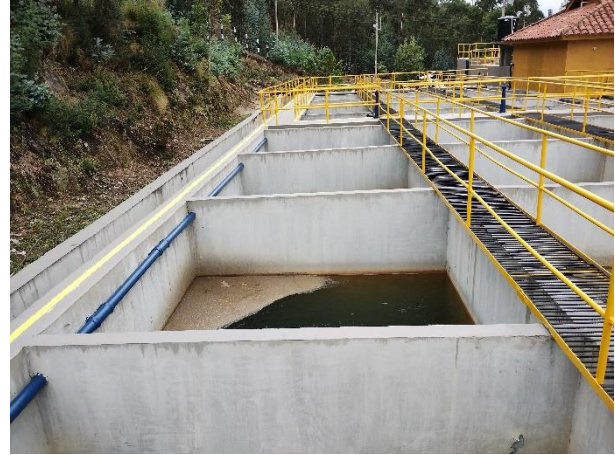
Celdas de floculadores
