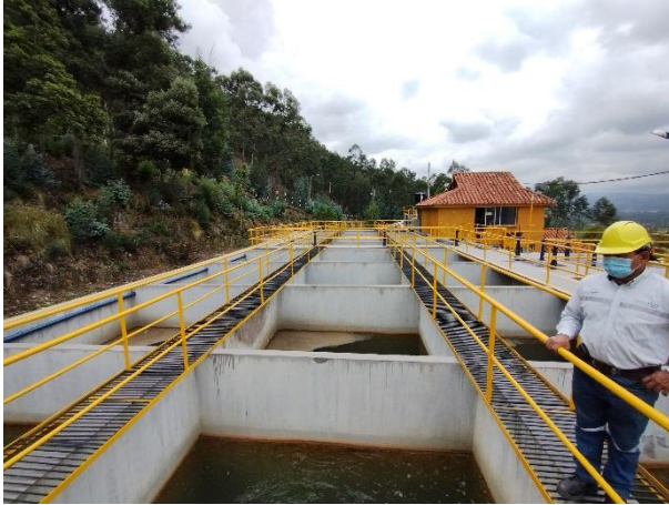
Sistema de floculación
