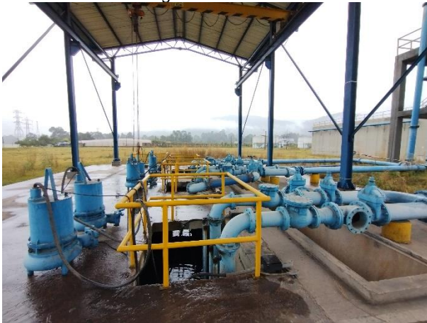
Estación de bombeo
