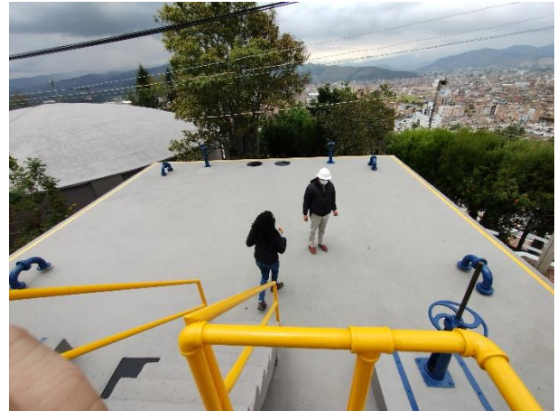
Tanque de aguas filtradas
