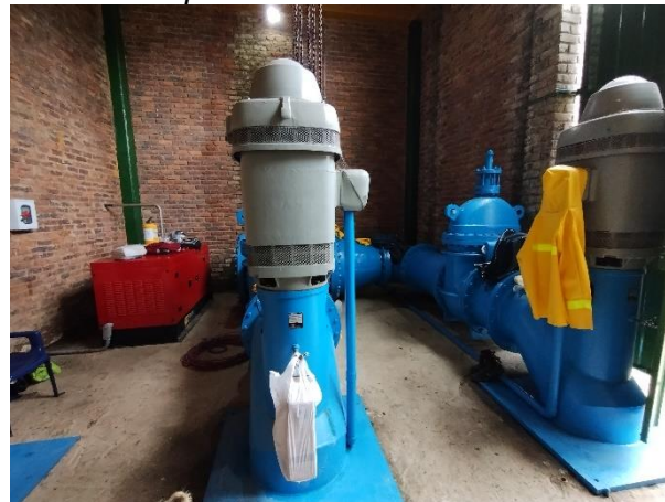
Sistema de bombeo
