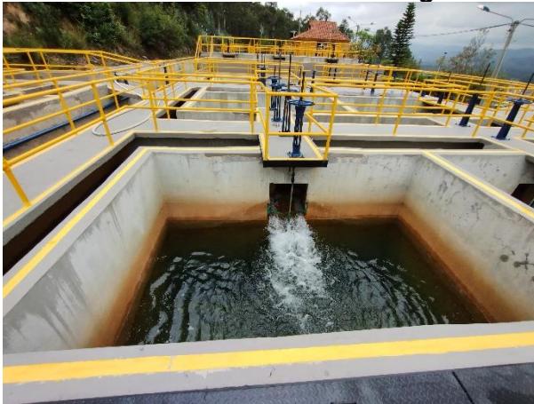
Sistema de filtración descendente
