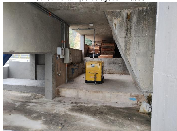
Planta de energía
