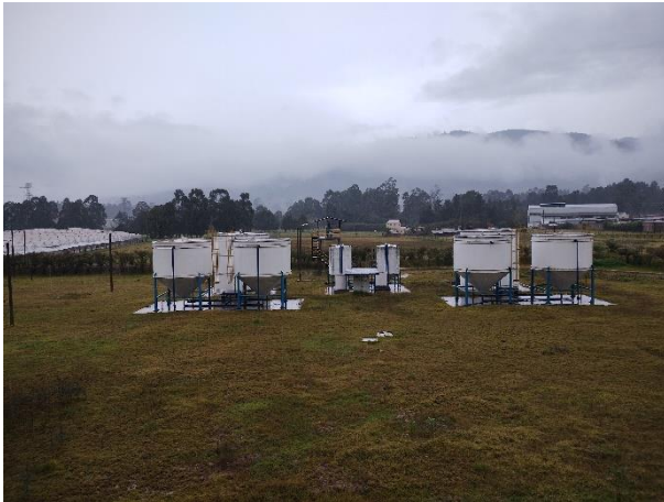
Tratamiento de lodos
