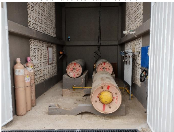
Cilindros de cloro gaseoso
