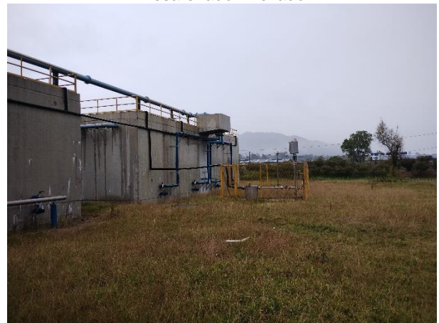
Quemador de biogás
