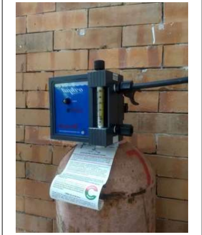
Imagen 38 Dosificación cloro gaseoso
