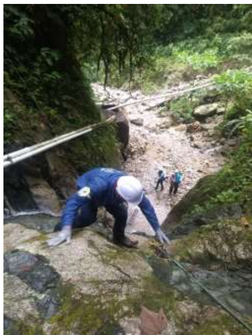
Imagen 26 Línea de aducción Quebrada El Conejo en 6"
