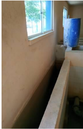
Sistema de dosificación de desinfección con cloro Fuente: Visita SSPD, abril de 2019
