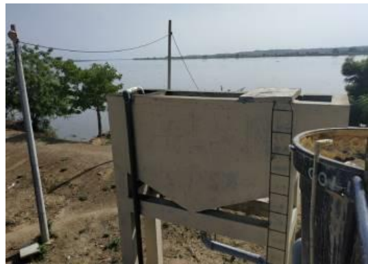
Desarenador a la llegada de la planta
