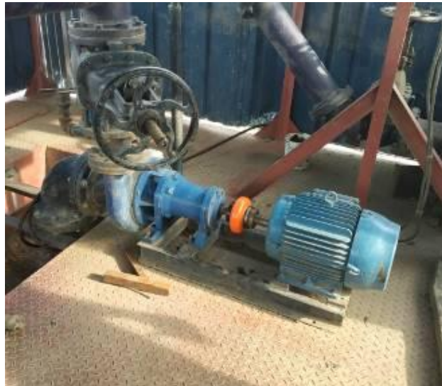
Conjunto Bomba Motor en la barcaza
