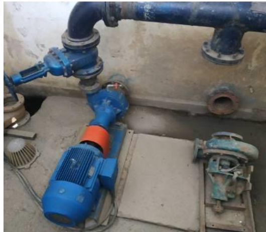
Conjunto Bomba Motor se observa la suplencia sin servicio Fuente: Visita SSPD, abril de 2019
