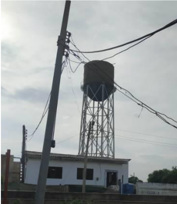
Tanque Alto 450 m3
