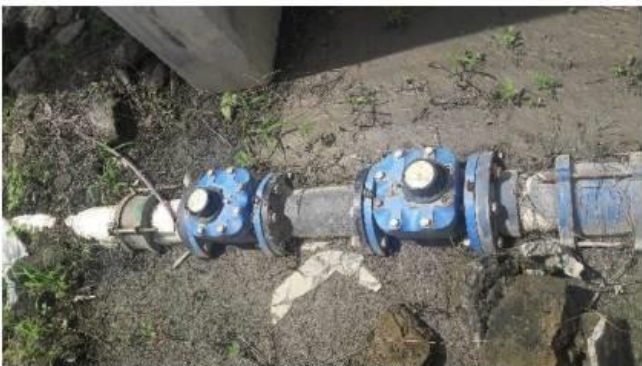
Macromedidores a la llegada de la planta sin funcionamiento
