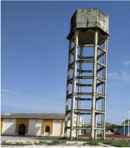
Tanque Elevado Barranca Viejo 200 m 3
