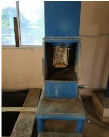
Estructura de dosificación de sulfato
