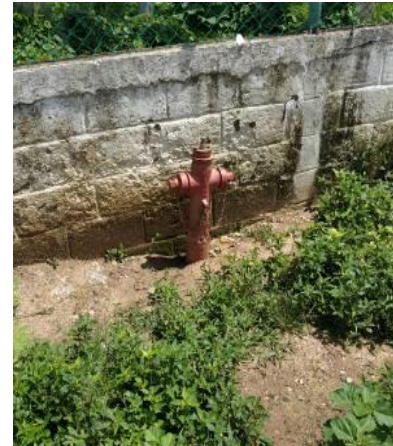
Hidrante en la red de distribución
