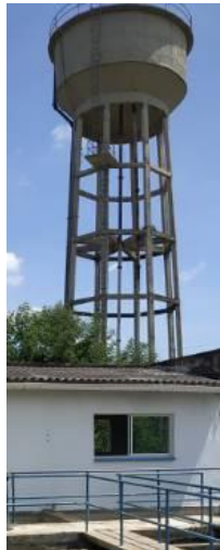
Tanque Elevado 400 m 3
