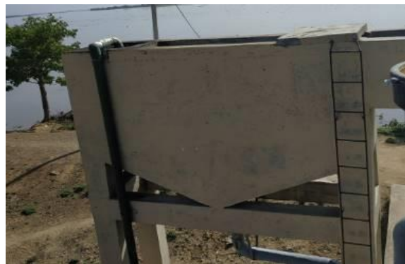
Desarenador a la llegada de la planta
