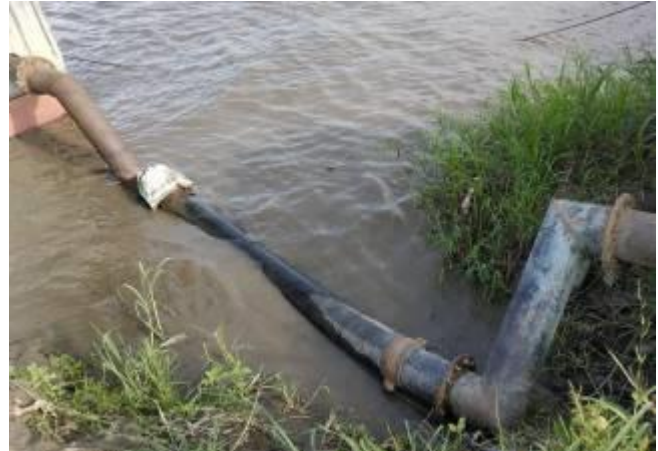
Detalle de la tubería en funcionamiento
