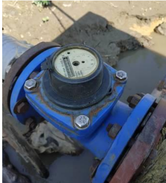
Macromedidor fuera de servicio
