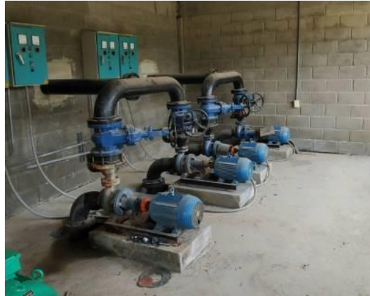
Bombas de eje horizontal instaladas en la planta Fuente: Visita SSPD, abril de
