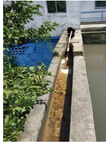
Estructura de llegada a la planta, Parshall para mezcla rápida
