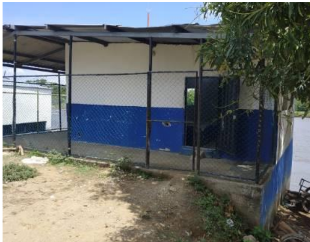
Imagen 22. Caseta de captación para pozo de fondo
