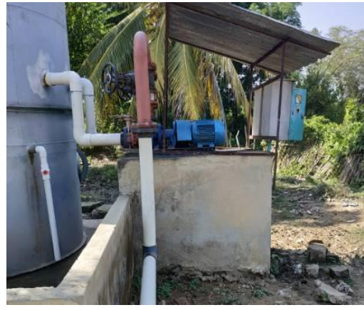
Sistema de bombeo al tanque y a la red de distribución
