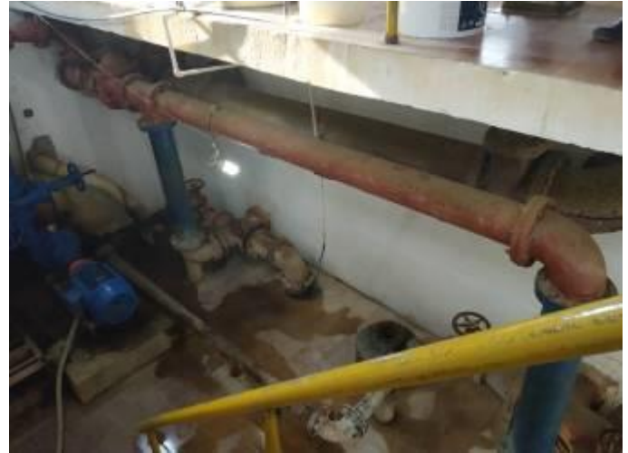
Tanque de aguas claras donde se realiza la adición de cloro.
