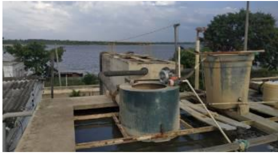
Mezcla de sulfato y floculación
