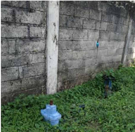
Accesorios de las válvulas de abastecimiento
