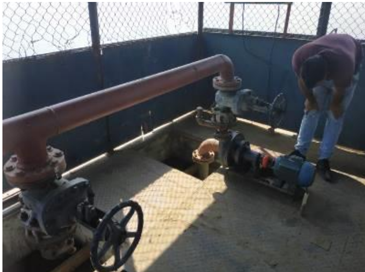
Vista frontal EBAC No existe bomba de suplencia
