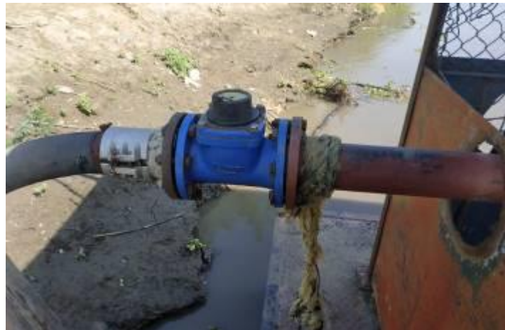
Existen macromedidores en mas estado y no registran los caudales. Fuente: Visita SSPD – abril de 2019
