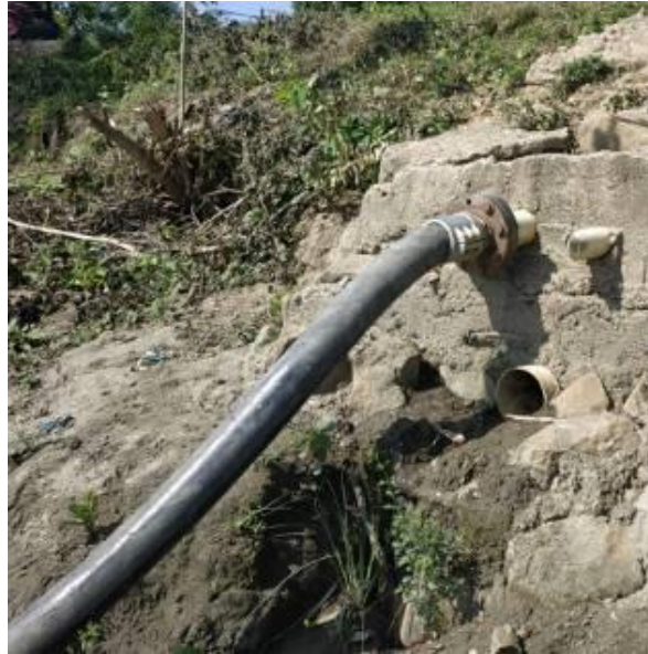
Detalle de la aducción en polietileno Fuente: Elaboración SSPD, visita de abril de 2019
