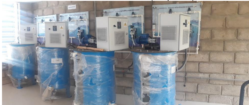
Equipamiento dosificación de químicos (No operativos)
