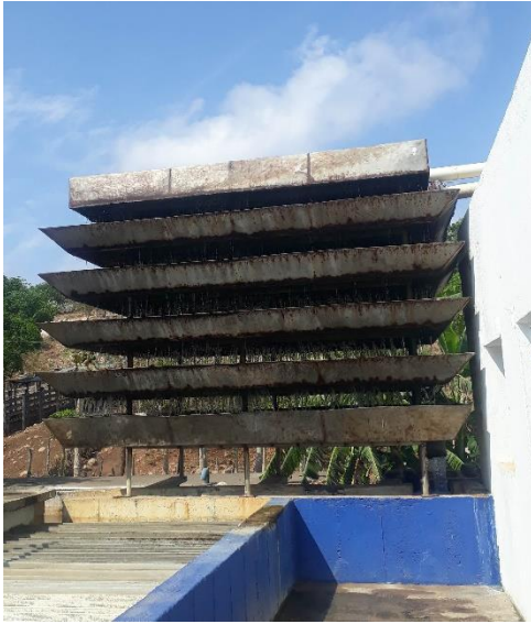
Filtros de carbón coque
