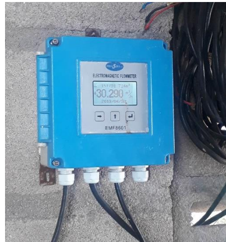
Macromedidor de una de las salidas de la PTAP
