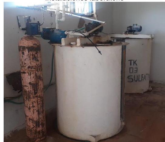
Dosificación de cloro
