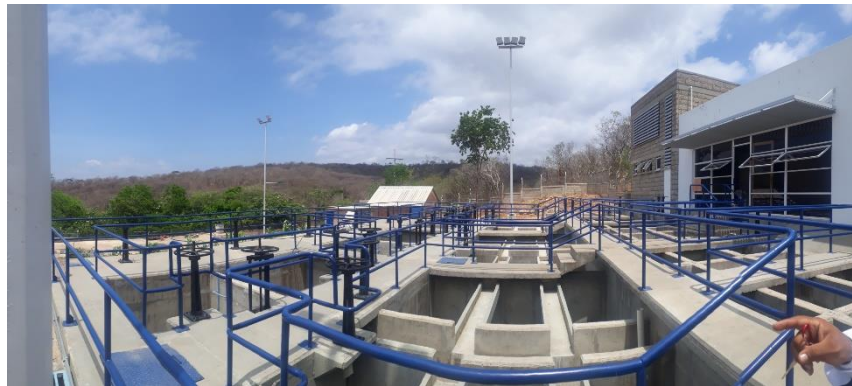
Vista lateral PTAP Cabellona (No operativa)
