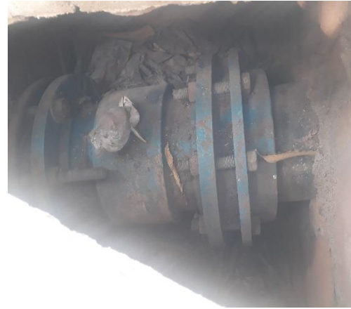
Macromedidor fuera de servicio
