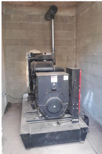
Planta de respaldo fuera de operación
