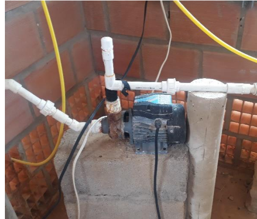
Estación dosificación de cloro Fuente: Visita de inspección SSPD
