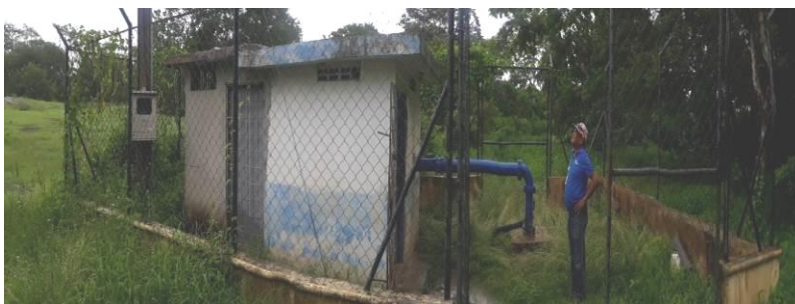
Imagen 4. Pozo Sabana de Cali
