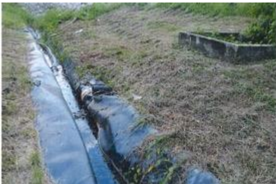
Imagen 35. Canales de agua lluvia
