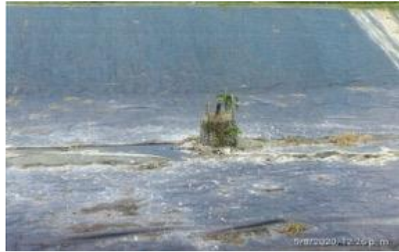
Imagen 32. Chimenea de la celda número 6 sin mantenimiento.
