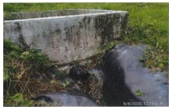
Imagen 36. Tanque de inspección de lixiviados
