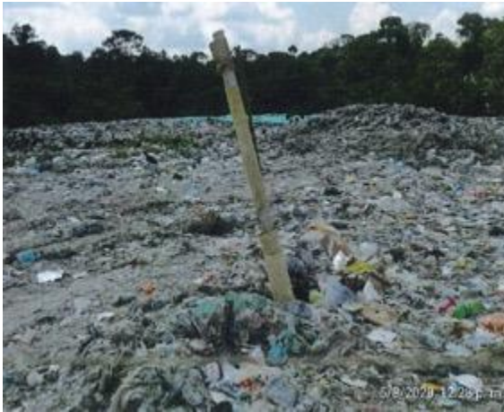
Imagen 39. Chimenea se evidencia que perdió su posición vertical.
