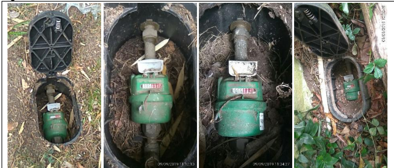
Imagen 16. Micromedidores instalados en acometidas domiciliarias de la Parcelación Floresta de la Sabana.
