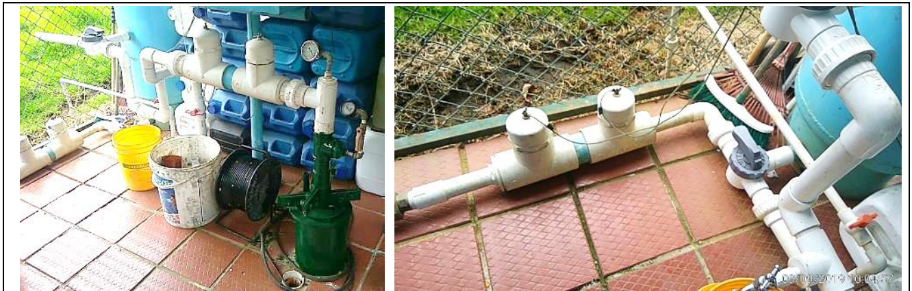
Imagen 8. Tubería de impulsión, que incluye primer macromedidor y puntos de inyección de químicos.
