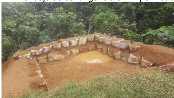
Imagen 24. Pondaje de contingencia sin impermeabilización.
