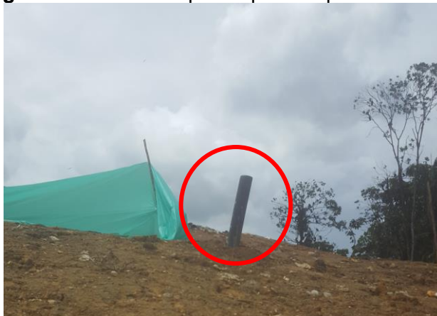
Imagen 25. Chimenea que ha perdido posición vertical.
