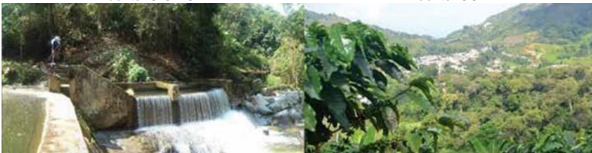
Infraestructura instalada para la MCH El Palmor. Fuente: CCEP
