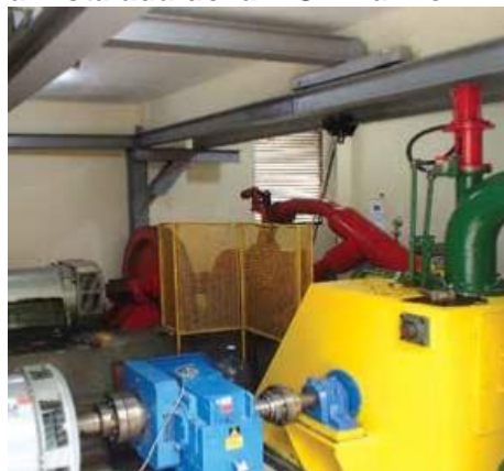
Turbina de la casa de máquinas. Fuente: CCEP
