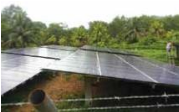
Sistema fotovoltaico instalado en Puerto Soldado. Fuente: CCEP
