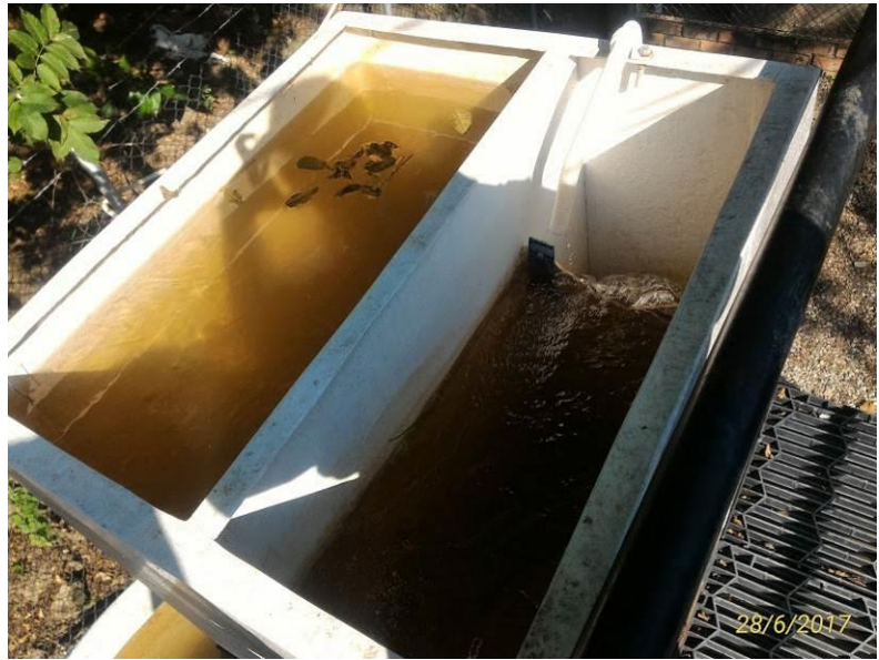
Foto 10 Mezcla rápida y floculación
