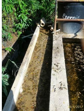
Foto 4 Canal de entrada PTAP 1
