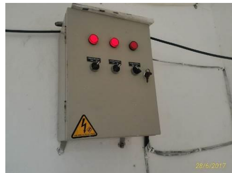
Foto 15 Tablero de control
