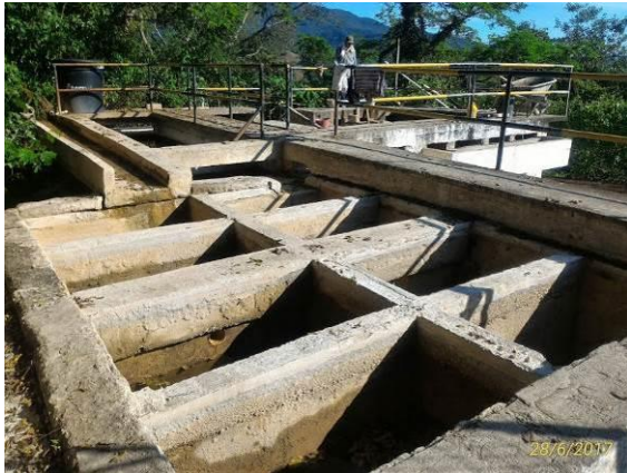
Foto 3 PTAP 1 Casco Urbano
