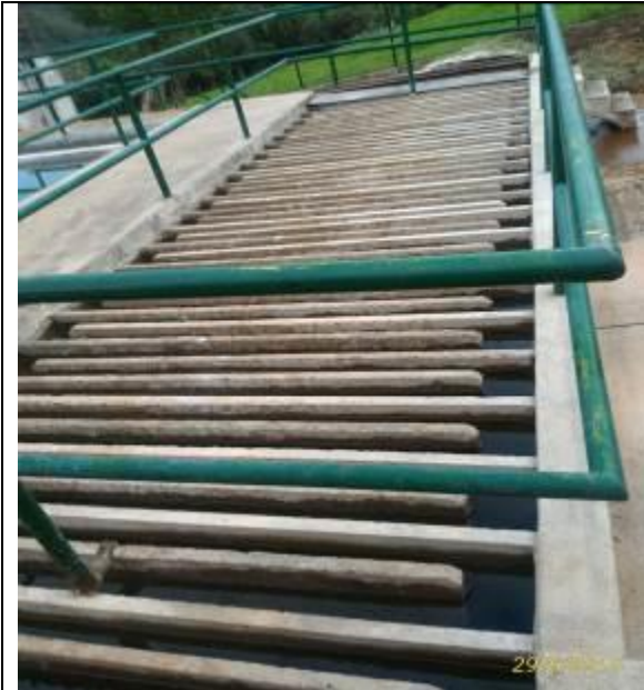
Fotografía 6 Unidad de floculación horizontal
