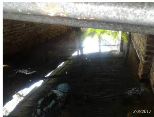
Foto 4 Interior caseta de Captación
