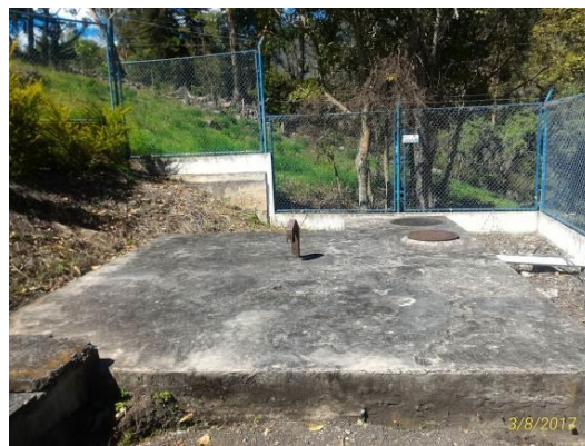
Foto 5 Tanque de almacenamiento semienterrado
