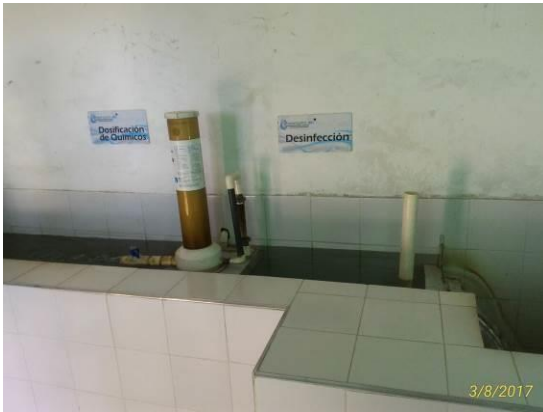
Foto 3 Canaleta aplicación desinfectante
