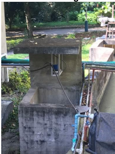
Medición del caudal a la entrada de la PTAP
