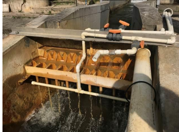
Adición de los coagulantes
