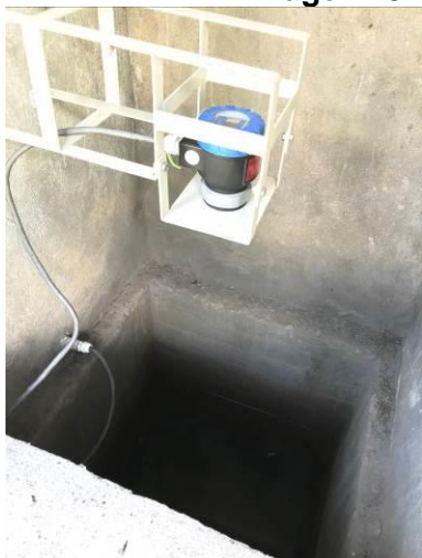
Sensor de nivel ubicado en la canaleta parshall
