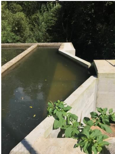
Entrada del flujo al desarenador
