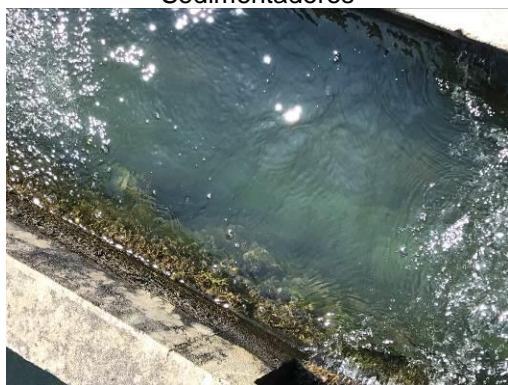
Algas en las paredes de los sedimentadores
