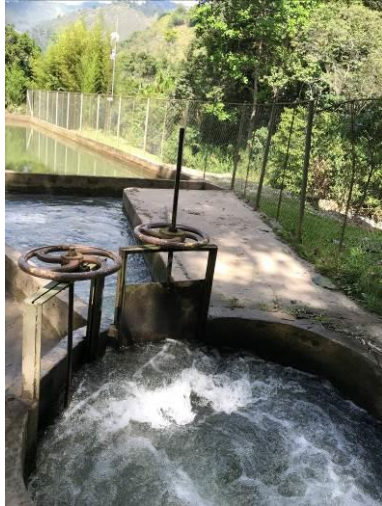
Entrada del flujo al desarenador
