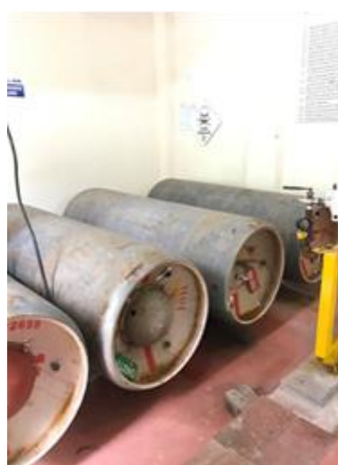
Cuarto de cloración
