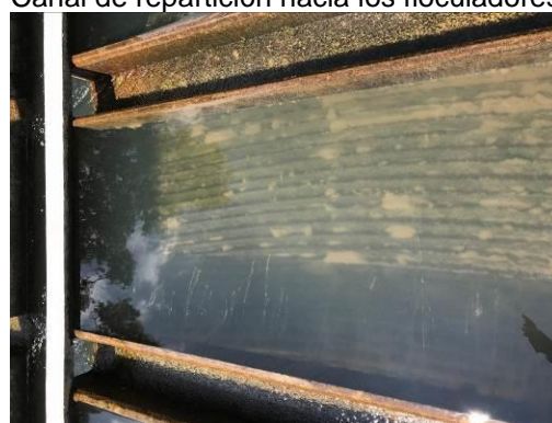
Placas inclinadas de los sedimentadores
