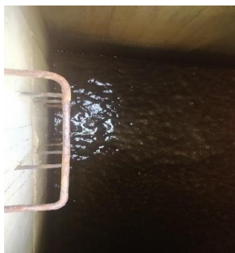
Fotografía N°55 Tanque de contacto de cloro
