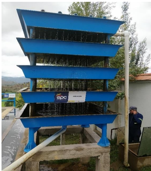
Fotografía N°45 Bandeja de aireación y tubería de ingreso
