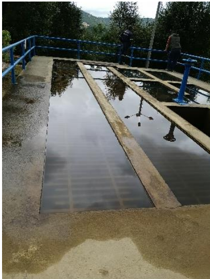
Fotografía N°51 Floculador flujo horizontal
