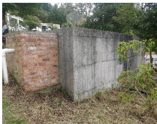
Fotografía N°56 Tanque de contacto de cloro
