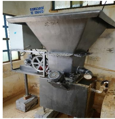
Fotografía N°48 Dosificador Sulfato de Aluminio
