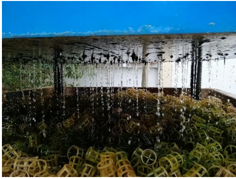
Fotografía N°4 7Bandeja de aireación -Interior
