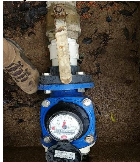
Fotografía N°44 Macromedidor de entrada
