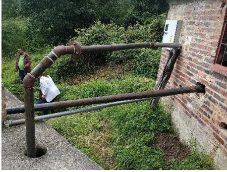
Fotografía N° 6 Tubería de succión
