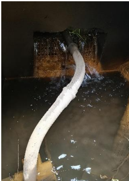
Fotografía N°37 Captación del agua
