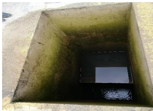
Fotografía N°54 Sedimentador de alta tasa
