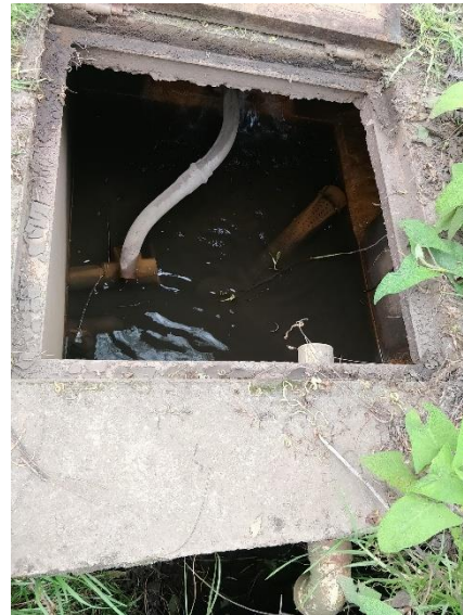
Fotografía N°38 Estructura de captación y punto de llegada de la tubería del sistema Borrachero
