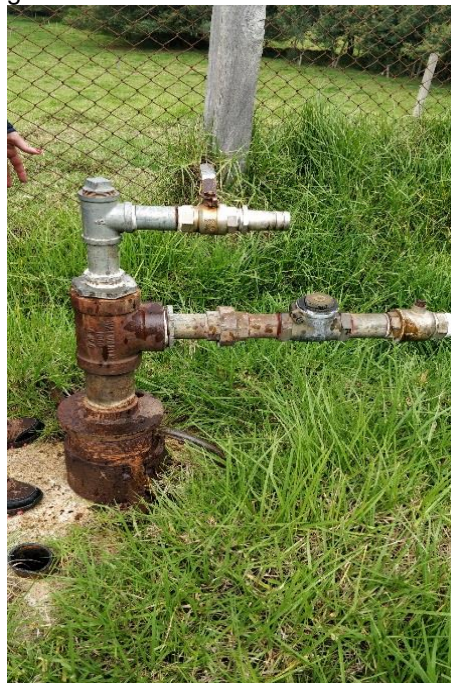
Fotografía N°35 sistema de bombeo
