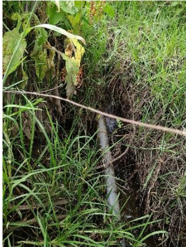
Fotografía N° 32 Tubería de aducción
