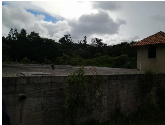
Fotografía N° 8 – Tanque de almacenamiento a la espera de entrar en operación.
