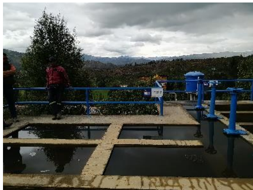
Fotografía N°53 Sedimentador de alta tasa
