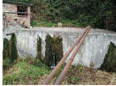
Fotografía N° 7 Tanque de succión
