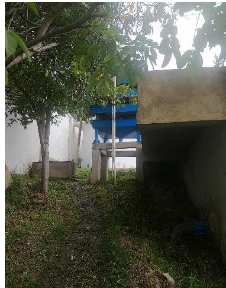
Fotografía N°46 Tubería de ingreso Pozo el Tejar
