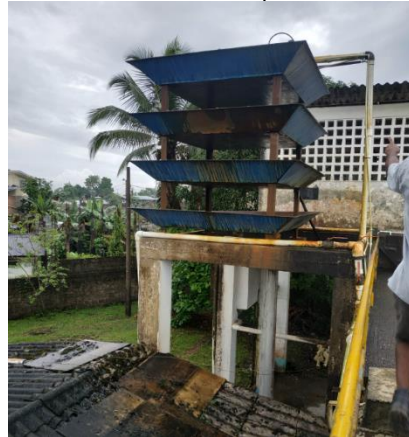
Aireador estación de bombeo pozo Barrio El Jardín
