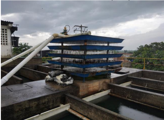
Aireador estación de bombeo pozo planta
