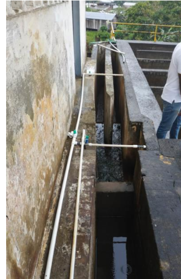
Estructura hidráulica de coagulación
