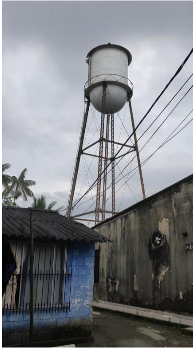
Imagen 18. Tanque de almacenamiento elevado planta de tratamiento
