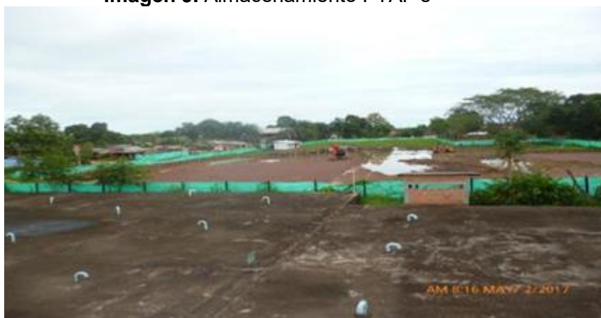
Almacenamiento del sistema de tratamiento de agua potable Fuente: Registro fotográfico visita SSPD a EMPOAGUAS E.S.P
