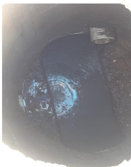
Pozo red de alcantarillado
