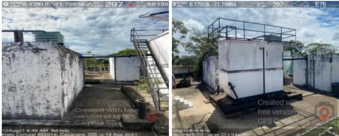
Figura 12. PTAP compacta fuera de operación
