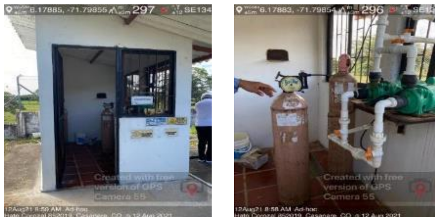
Figura 9. Caseta de desinfección
