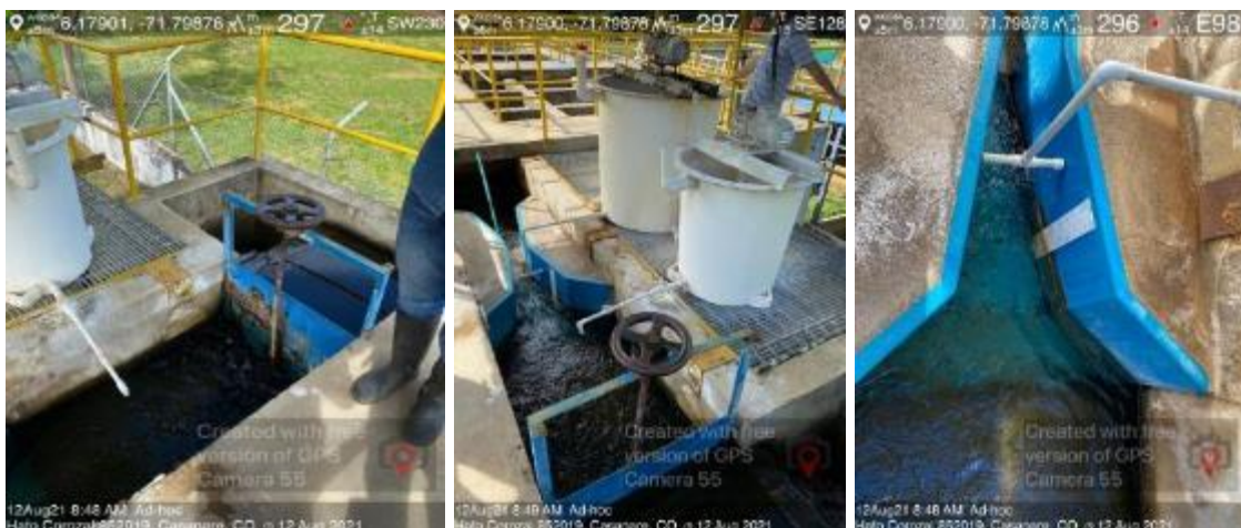
Figura 4. Cámara de quietamiento y proceso de coagulación - canaleta Parshall
