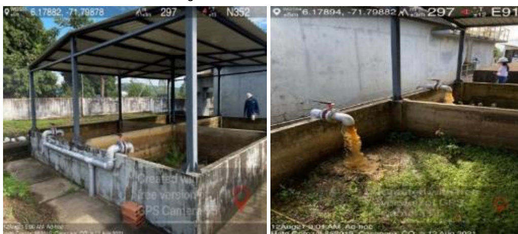
Figura 11. Tratamiento de lodos
