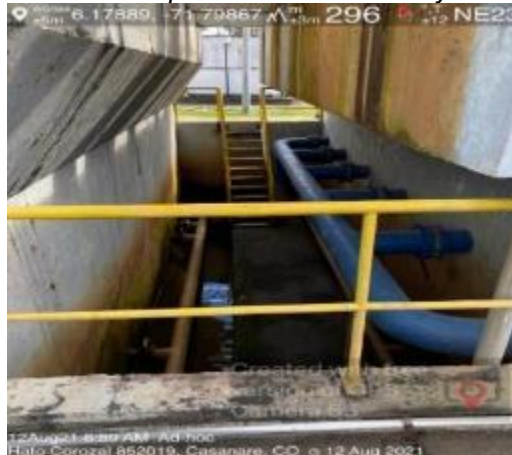
Figura 6. Válvulas para retiro de lodos y sedimento
