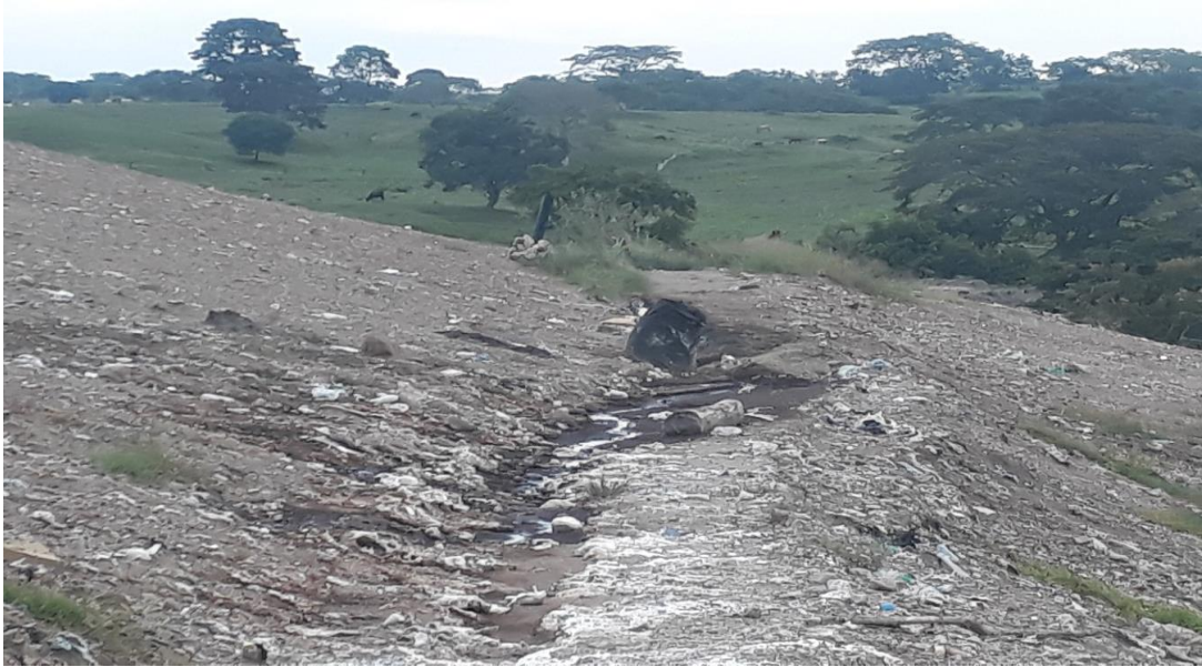
Imagen 112. Afloramiento de lixiviados en la celda 5
