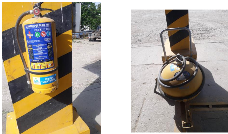
Imagen 75. Equipos contra incendio Base de Operaciones.
