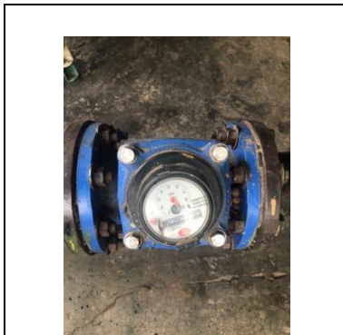
Imagen 21 Macromedidor fuera de servicio.
