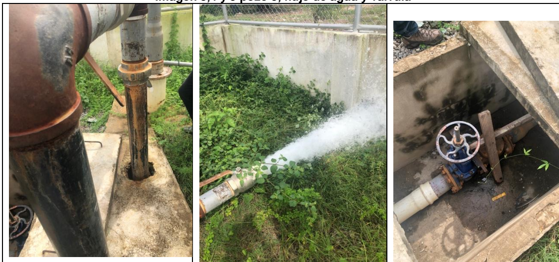
Imagen 3,4 y 5 pozo 3, flujo de agua y válvula
