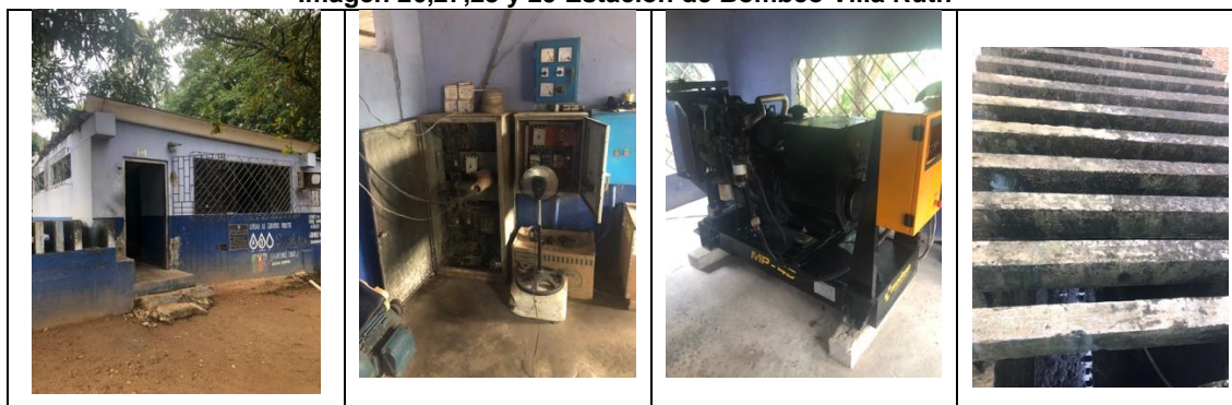
Imagen 26,27,28 y 29 Estación de Bombeo Villa Ruth
