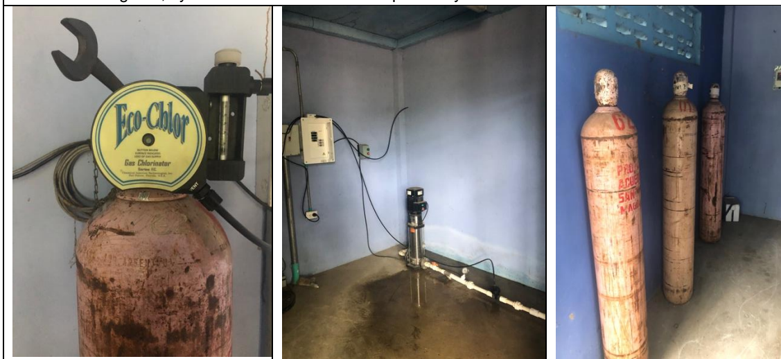
Imagen 8,9 y 10 Desinfección: insumos químicos y dosificador directamente en red
