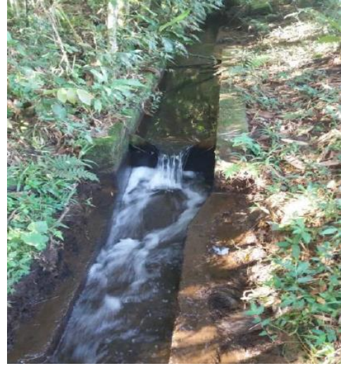
Captación quebrada La Amalia
