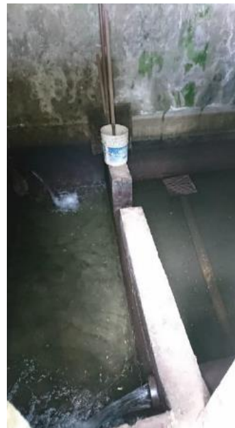
Desarenador quebrada La Amalia
