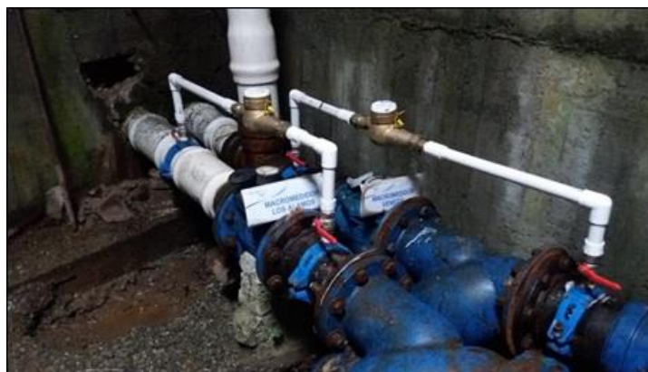
Macromedidores de salida de la planta
