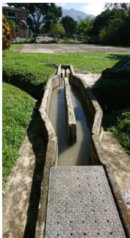
Canaleta parshall y desarenador
