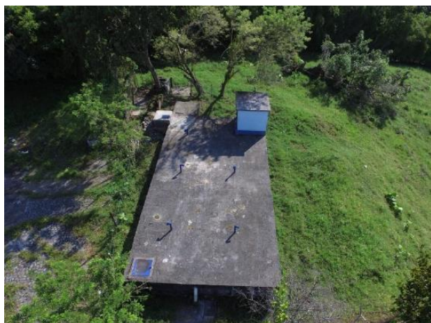
Tanque de almacenamiento
