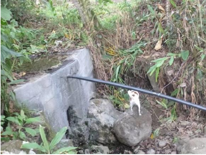
Captación quebrada La Amalia
