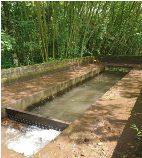
Desarenador quebrada La Tigra
