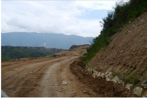
Foto 31. Canales de vías con material terreo y vegetación
