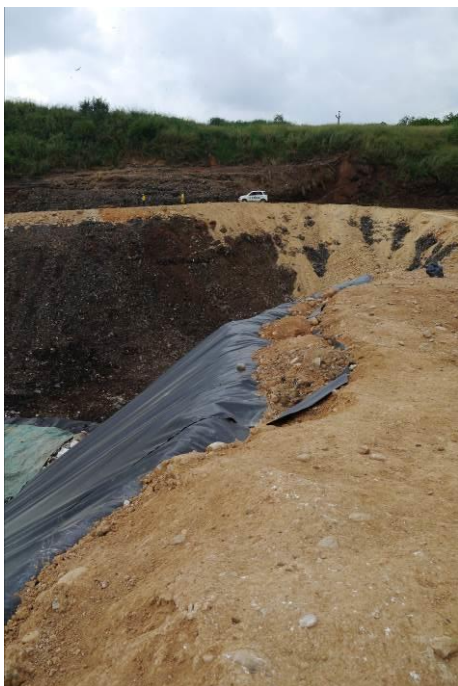
Foto 56. Ausencia de canales perimetrales en el vaso activo
