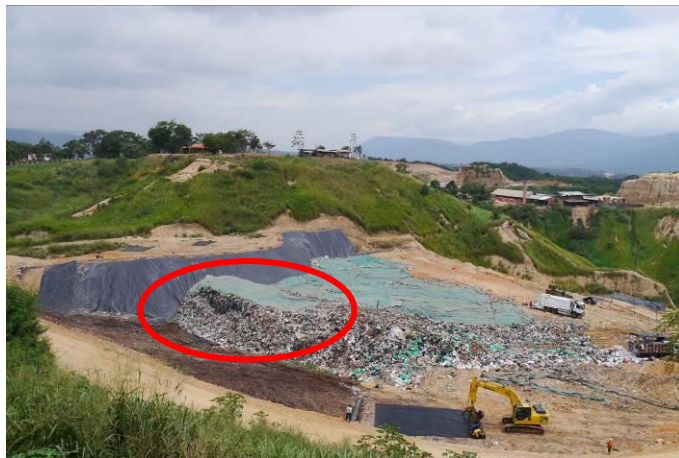
Foto 53. Áreas compactadas de residuos sólidos sin cobertura
