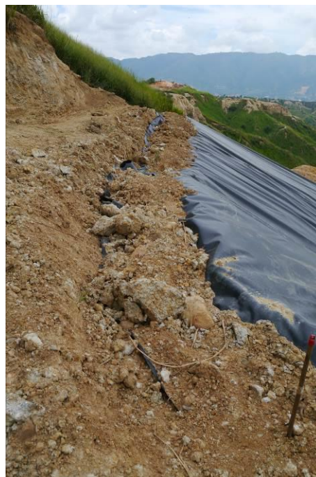
Foto 57. Ausencia de canales perimetrales en el vaso activo
