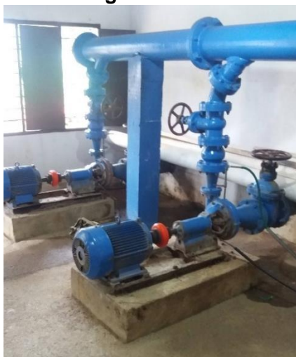
a) Equipos de bombeo San Carlos.
