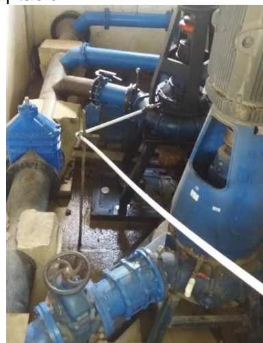
b) Equipos de bombeo
