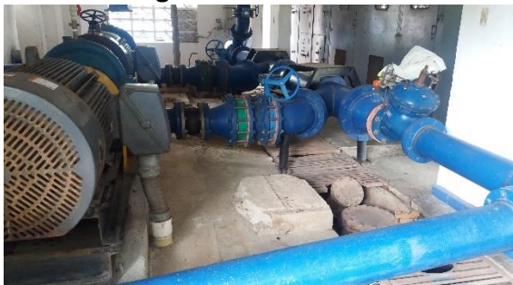
a) Equipos de bombeo Ciénaga de Oro
