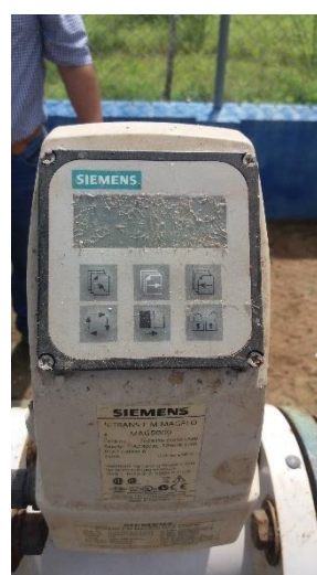
d) Equipo de macromedición Pozo No. 4
