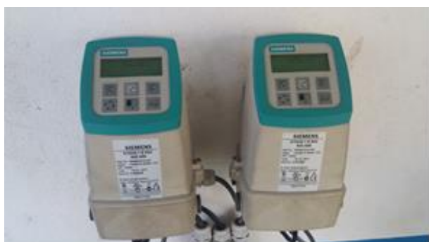
e) Equipos de macromedición
