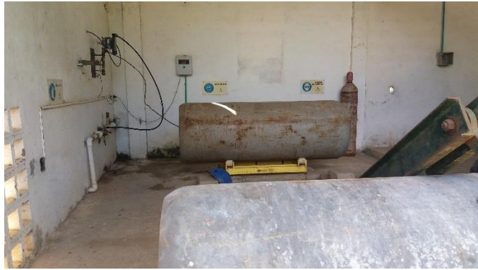
f) Tanques de cloro gaseoso
