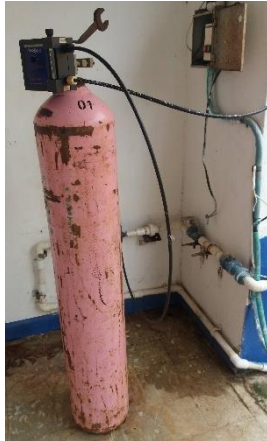
c) Re dosificación de cloro Ciénaga de Oro
