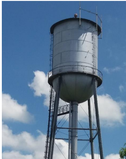
g) Tanque de almacenamiento
