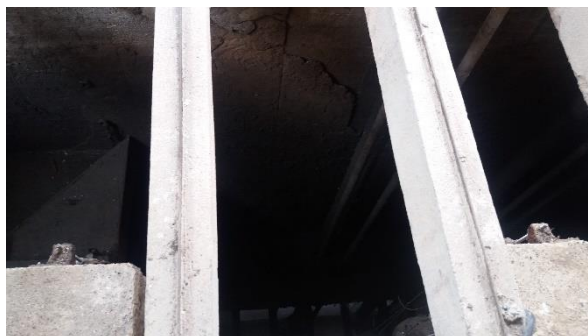
c) Pozo húmedo.
