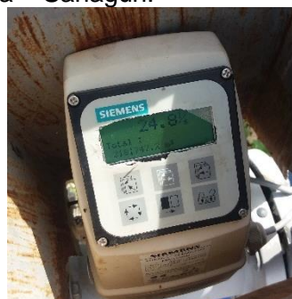
b) Equipo de macromedición Pozo No. 1
