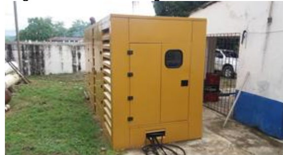
b) Planta de energía alterna
