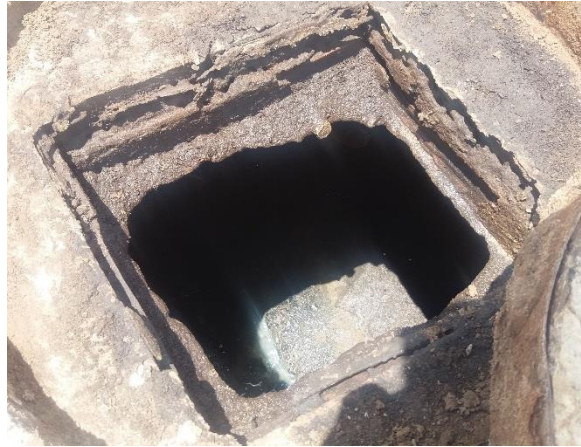
c) Pozo sistema Sahagún Fuente: Registro fotográfico SSPD – Visita junio de 2017
