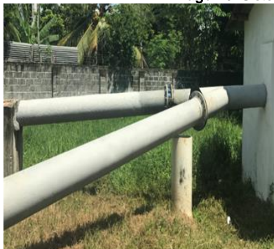
a) Tuberías de succión
