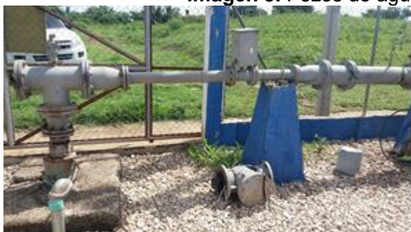
a) Pozo profundo No. 1
