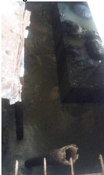
a) Pozo EBAR Venecia.
