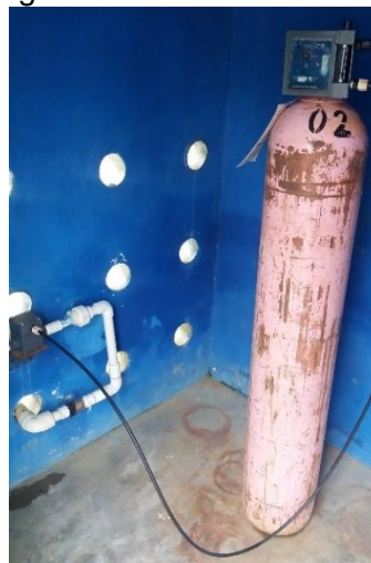
b) Redosificación de cloro San Carlos.
