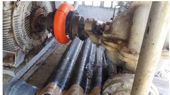
b) Fugas EBAP Conducción 2 y 4
