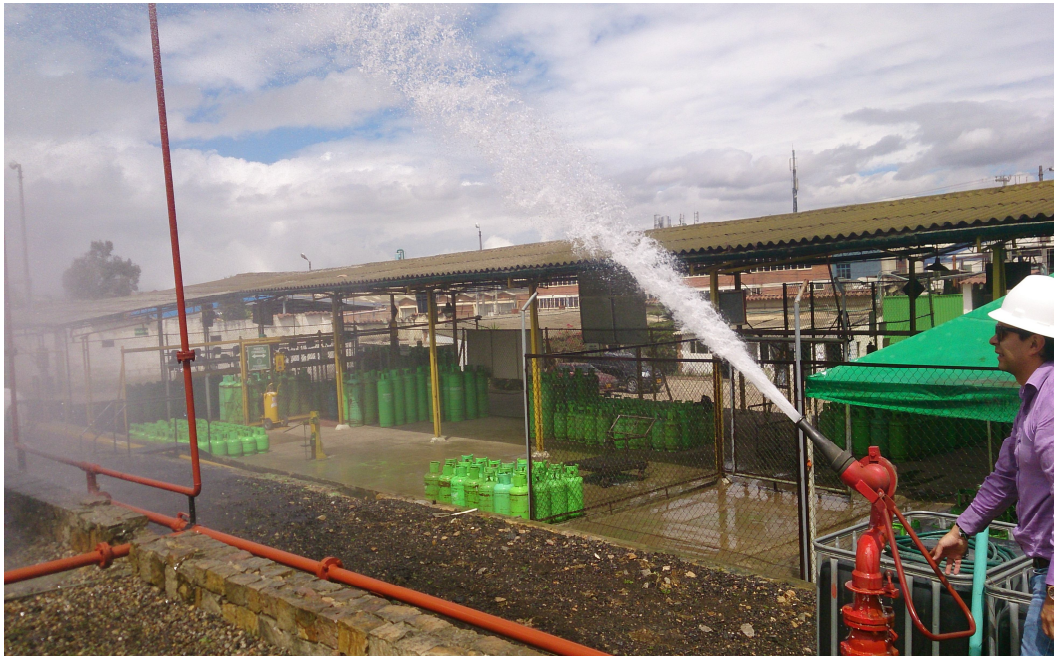
Foto 4 Sistema contraincendios en operación. Fuente: Datos de campo.
