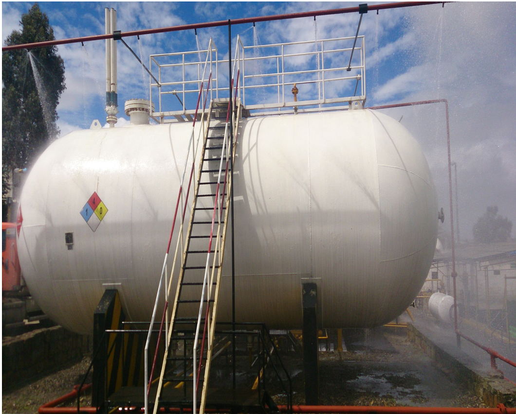
Foto 3. Sistema contraincendios en operación. Fuente: Datos de campo.
