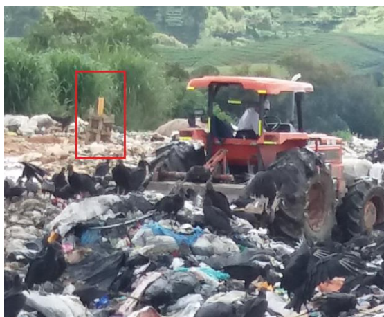
Imagen 14. Chimenea de extracción pasiva en el frente activo de trabajo
