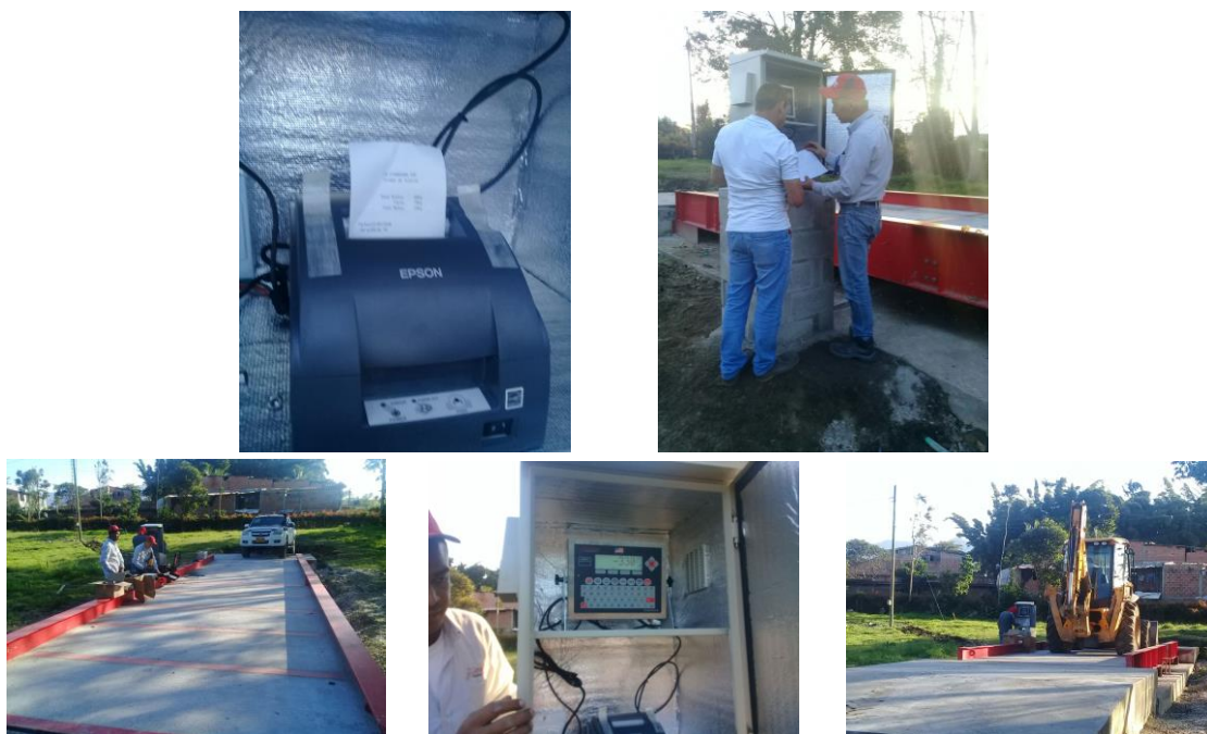
Imagen 8. Báscula camionera para el relleno sanitario de El Carmen de Viboral
