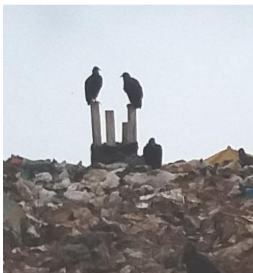
Imagen 13. Chimenea de extracción pasiva de gases
