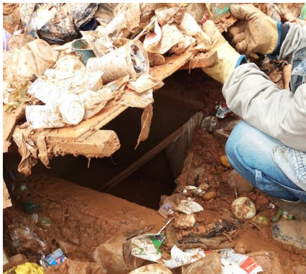
Imagen 11. Caja de recepción de agua lluvia
